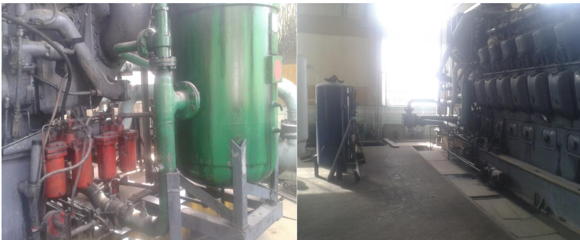
Imagen 26: Termogeneradores 1 y 2 (Centra Térmica Lligua)
