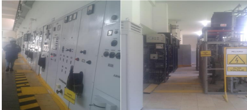
Imagen 19: Área de Tableros Eléctricos, y Redes Eléctricas
