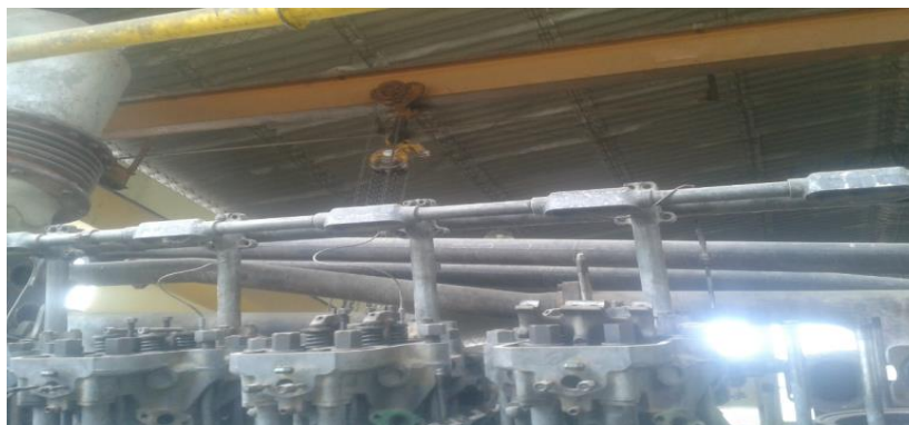
Imagen 27: Puente Grúa de la Central Térmica Lligua
