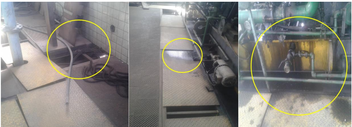
Imagen 14: Carencia de plancha antideslizante en el Área de Máquinas
