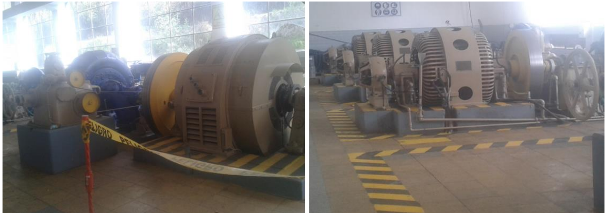
Fuente: Subestación Hidráulica La Península
