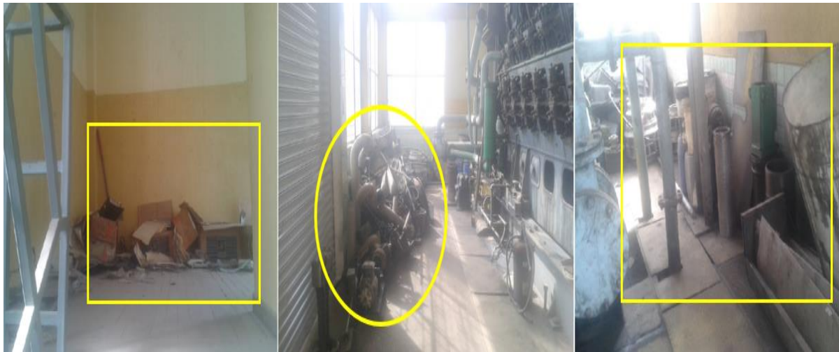
Imagen 9: Área de Máquinas de la Central Térmica Lligua
