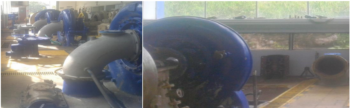
Imagen 17: Subestación Hidráulica La Península (Cuarto de Turbinas)
