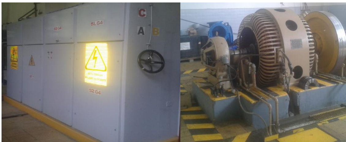
Imagen 18: Área de Maniobra en las Autogeneraciones
