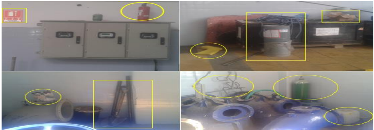
Fuente: Subestación Hidráulica La Península
