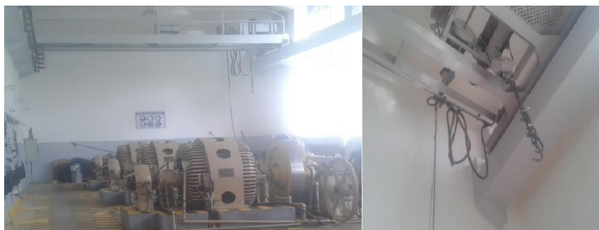
Imagen 24: Cuarto de Turbinas - Hidráulica La Península
