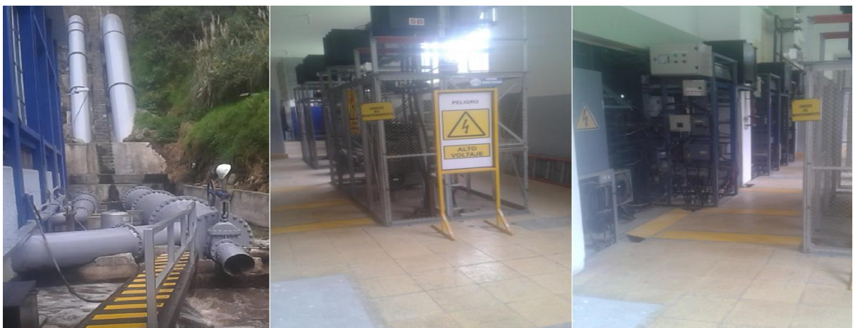
Imagen 20: Área de Tableros Eléctricos - La Península
