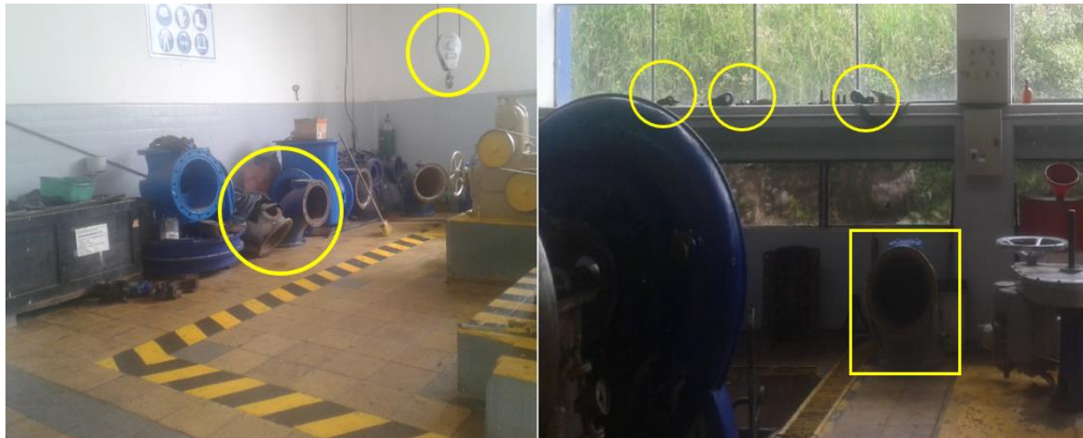
Imagen 4: Identificación de Objetos en mal estado.
