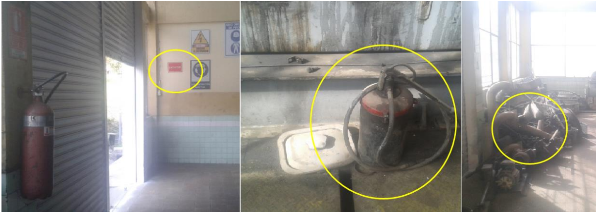
Imagen 15: Ubicación inadecua de extintores en el Área de máquinas
