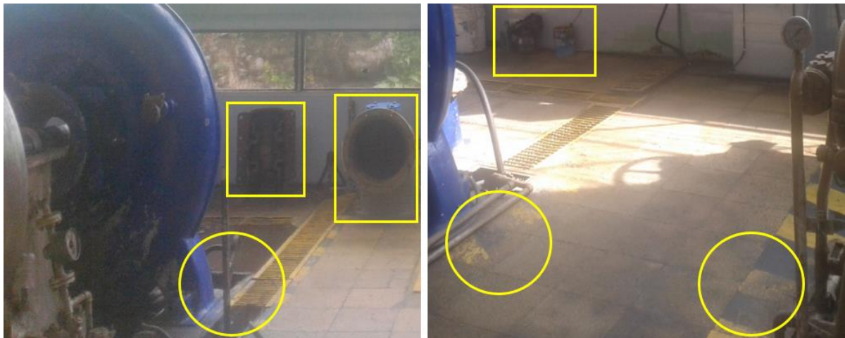
Fuente: Subestación Hidráulica La Península
