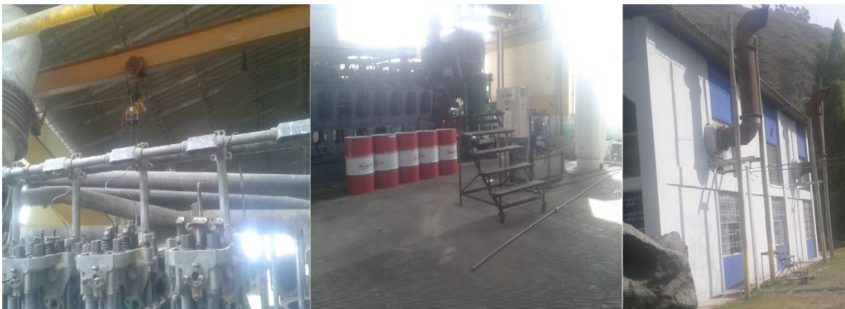
Fuente: Central Térmica Lligua
