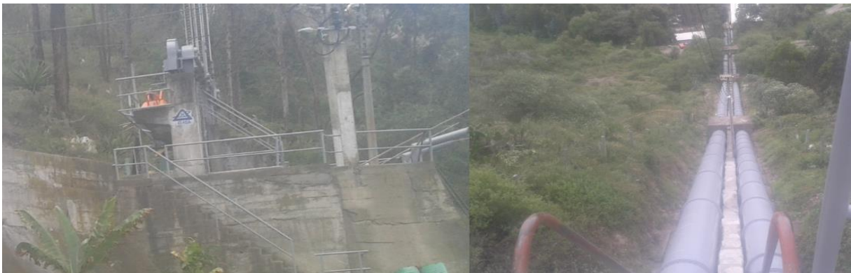
Imagen 22: Área Tanque de Presión - La Península
