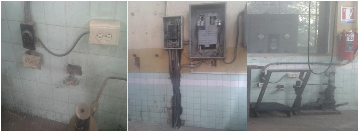
Imagen 16: Cables energizados al aire libre.
