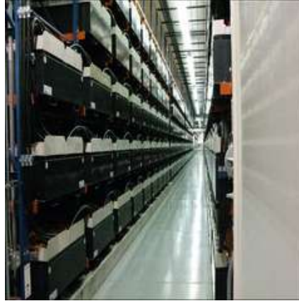
Figura 8. 14.- Instalación de sistemas de baterías de Ni-Cd, Alaska [26]
