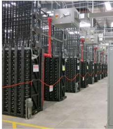
Figura 8. 12.- Parque Eólico Texas 36 MW sistema de baterías plomo- ácido [4]
