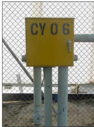
Figura 3.9. Tablero de conexiones Fuente: [4]
