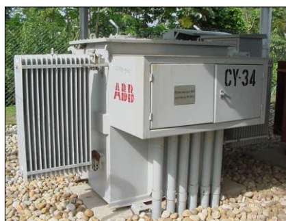
Figura 3.8. Transformador elevador Fuente: [4]
