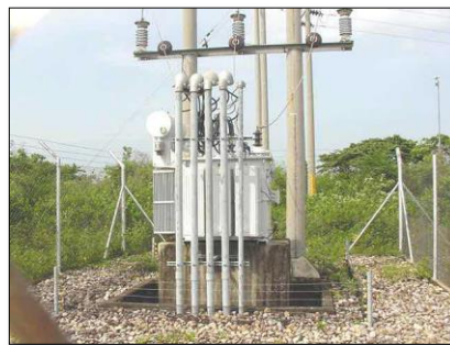
Figura 3.7. Transformador reductor Fuente: [4]
