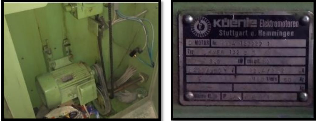
FIGURA 5. 11. Motor regulador de ancho y dato de placa
