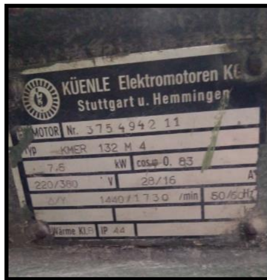
FIGURA 5. 7. Dato de placa del motor ventilador refrigerador
