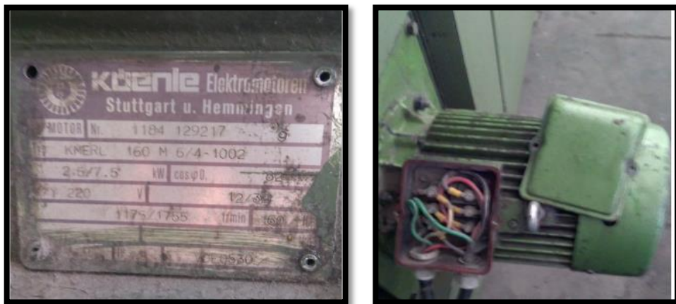
FIGURA 5. 3. Motor ventilador de aire caliente y dato de placa
