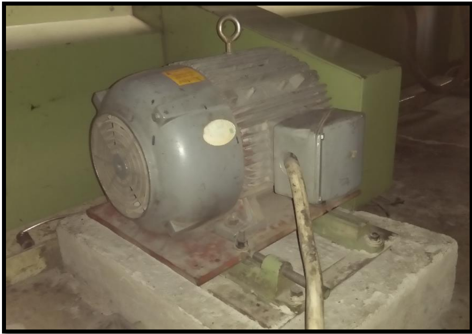
FIGURA 5. 8. Motor de accionamiento principal
