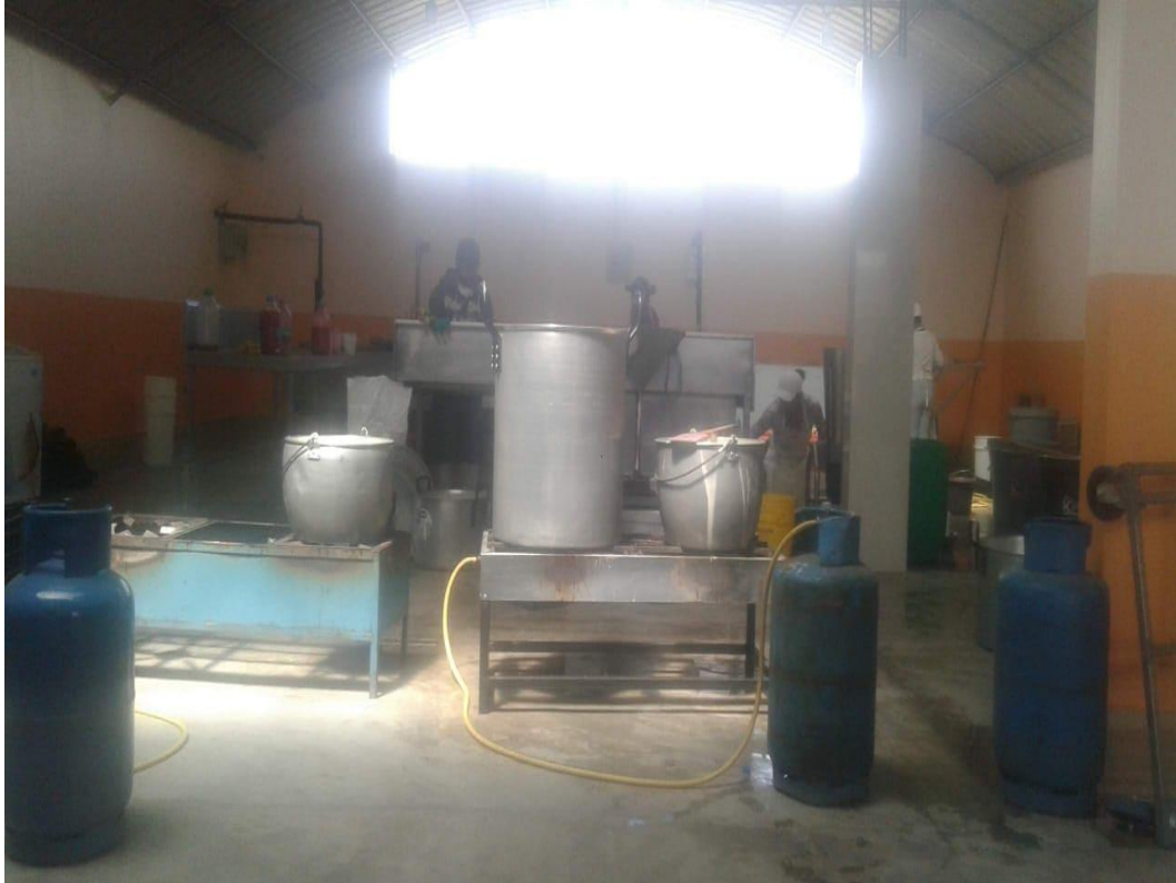
- Instalaciones de la empresa MELANIC, área de recepción de la materia prima.
