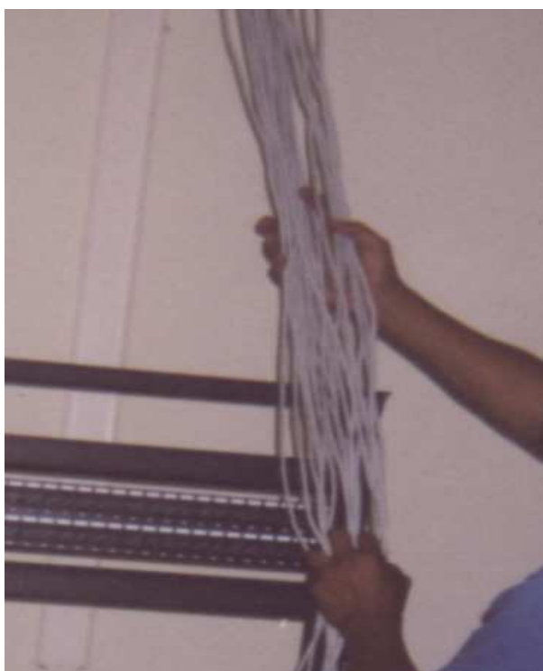
Figura 4.9. Peinado de Cable UTP (arreglo)
