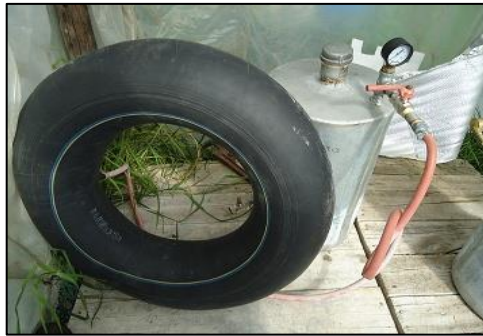
Figura 2.18. Gasómetro para almacenamiento de biogás.
