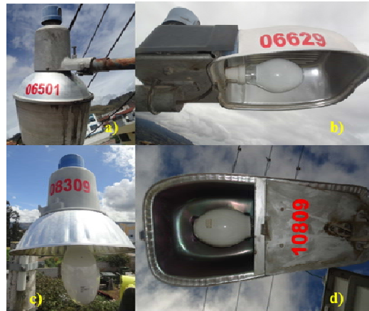
Grafico N° 4.3: Tipos de luminarias de mercurio instaladas en postes de hormigón dentro del área urbana del Cantón Ambato: a) Hg125W Abierta, b) Hg125W Cerrada, c) Hg175W Abierta y d) Hg175W Cerrada.
