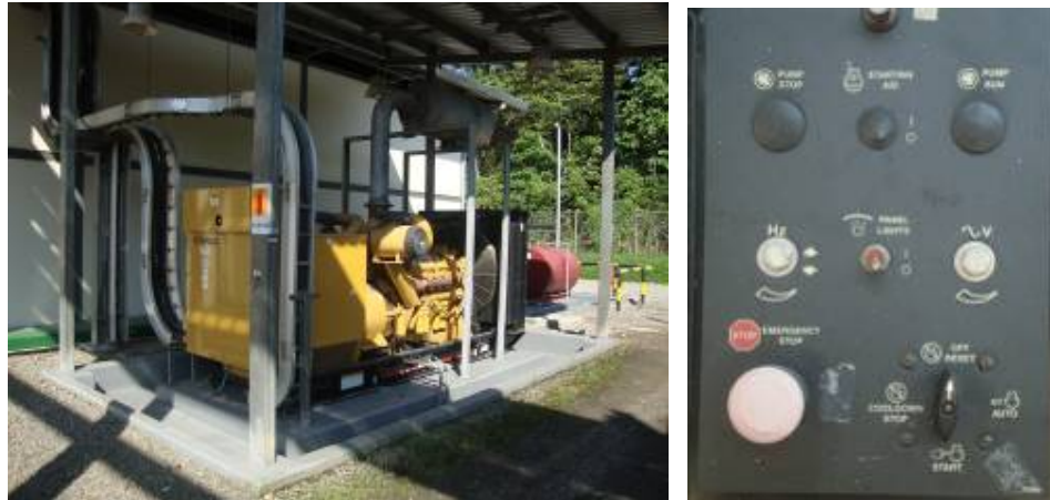
Figura 1. Generador de Black Start, Caterpillar y panel local de control
