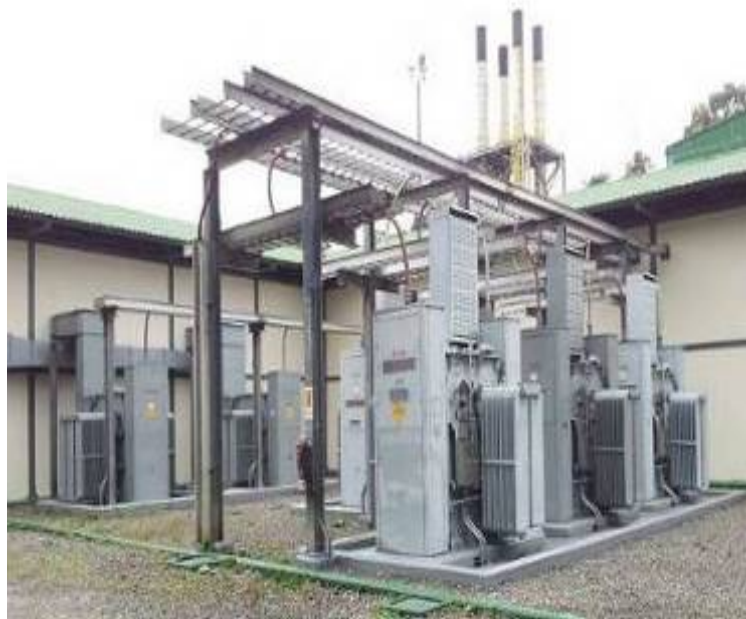
Figura 32 Sistema de transformación de voltaje
