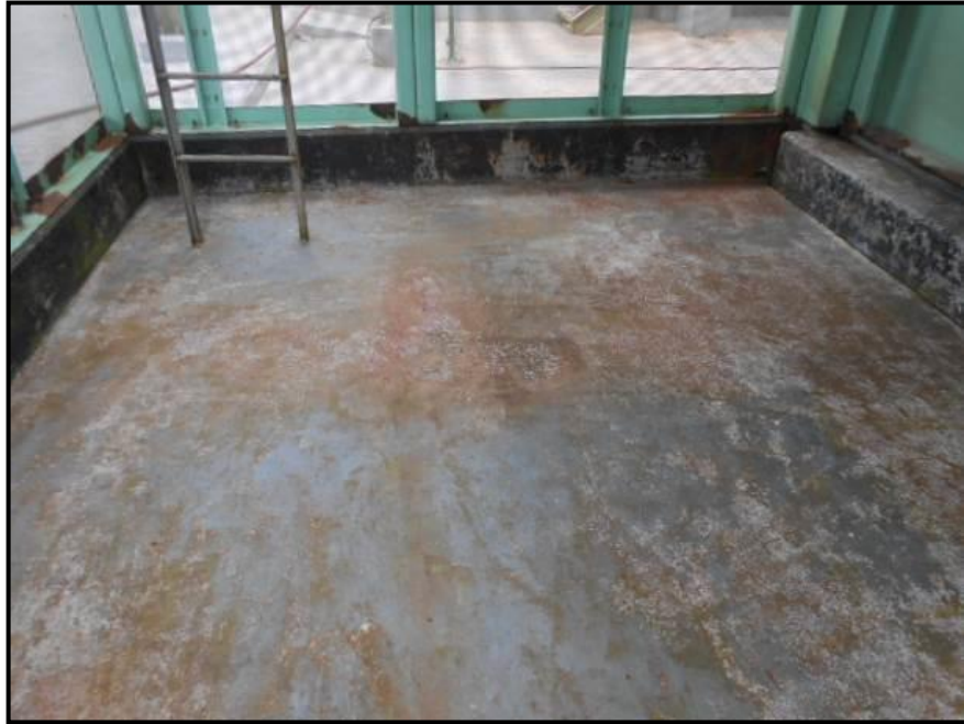
Figura 3.27 Oxidación en el piso del área de filtros de aire
