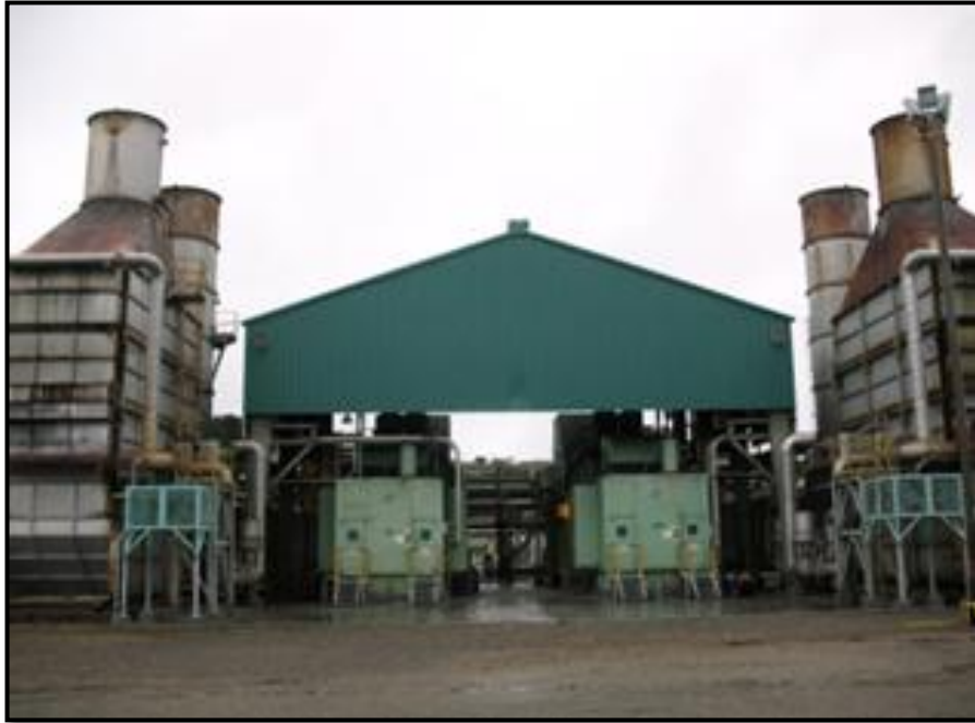
Figura 3.5 Turbinas TR-1170A y TR-1170B del campo NPF
