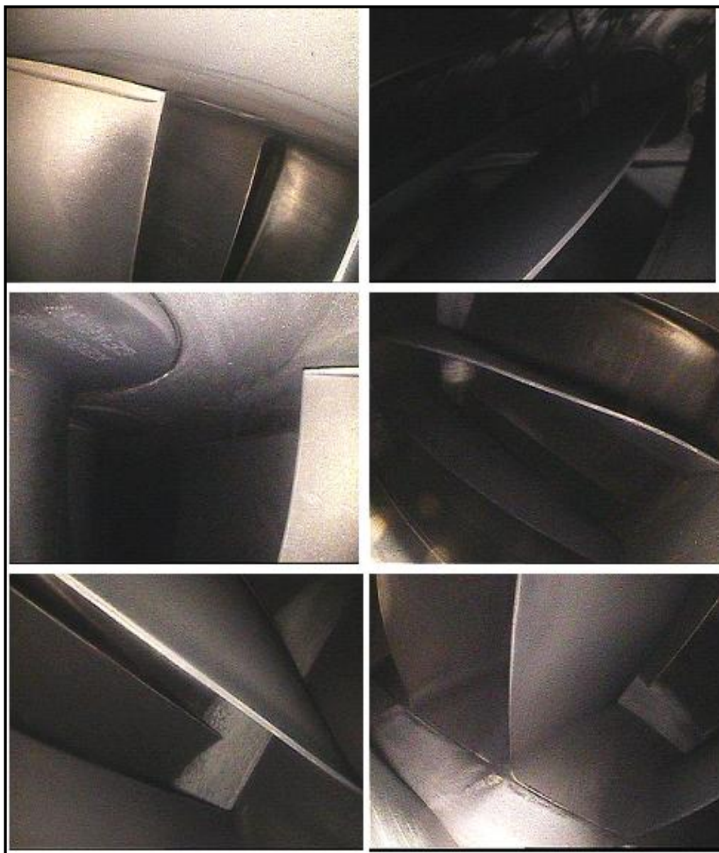
Figura 3.32 Inspección compresor de aire TR-1170B
