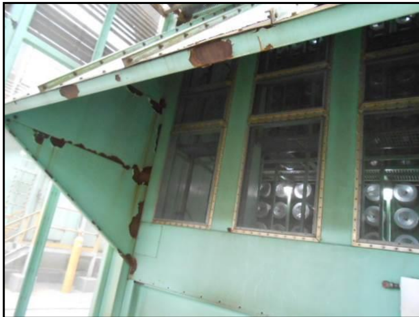
Figura 3.26 Recinto de ingreso de aire con oxidación
