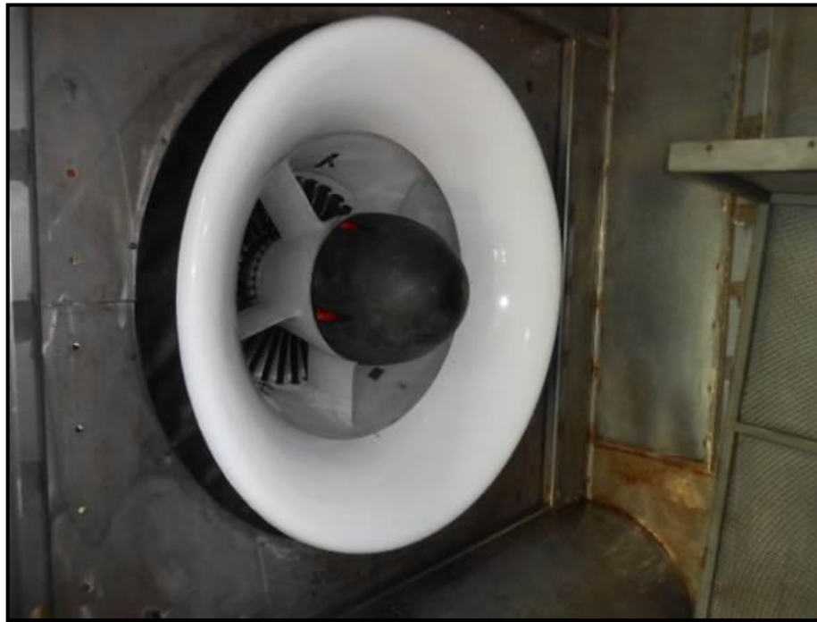
Figura 3.31 Ducto de ingreso de aire a la turbina
