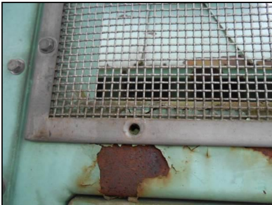
Figura 3.28 Oxidación y corrosión en área de filtros de aire
