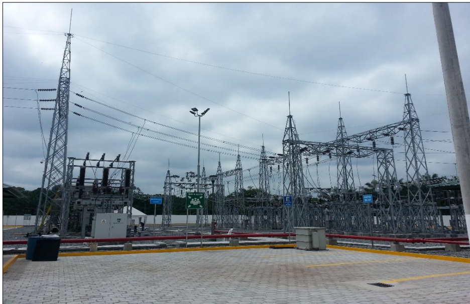
Gráfico N° 4. 3: Patio 69 kV Subestación Quinindé. Fuente: Subestación Quinindé – CELEC EP, 2015.
