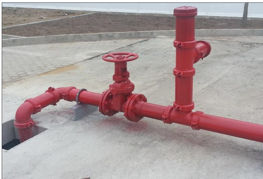
Gráfico N° 4. 8: Detalle de pintura en tubería de interconexión con cisterna.
