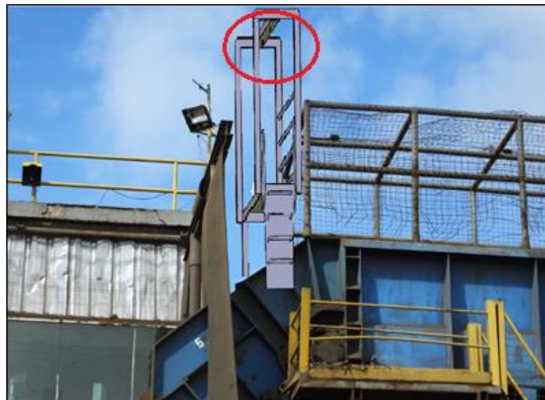
Gráfico N° 7: Ubicación del punto de anclaje en la zona de cortinas de seguridad - Fragmentadora Fuente: Propia
