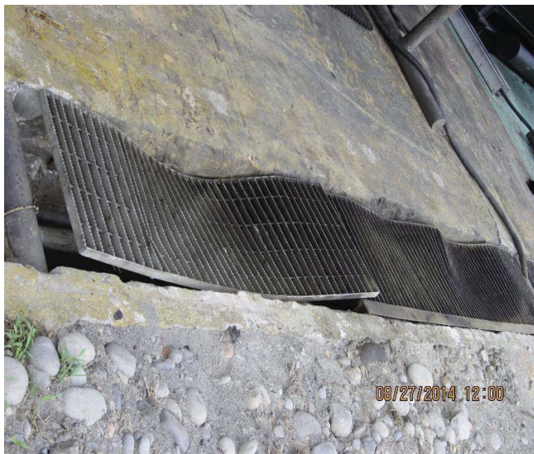
Ilustración 3 Rejillas zona de generadores
