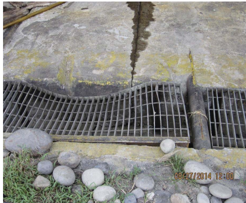
Ilustración 4 Rejilla zona de generadores
