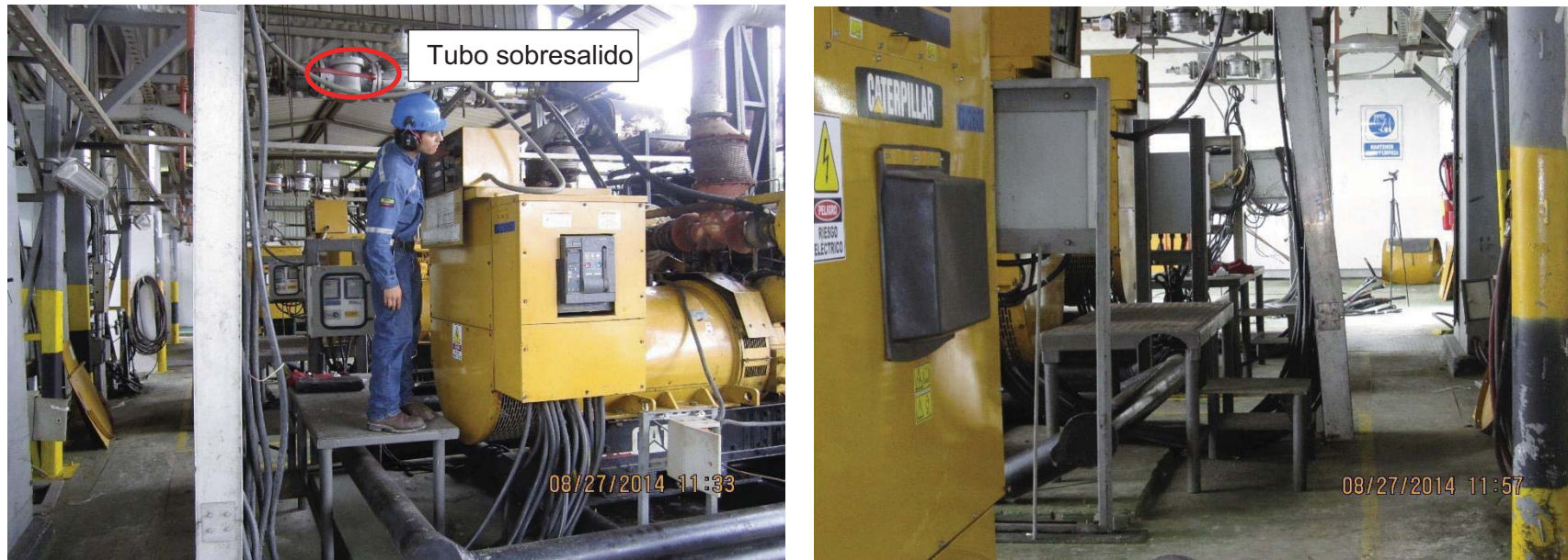
Ilustración 9 POSIBLE CAIDA A DISTINTO NIVEL DE LAS GRADILLAS
