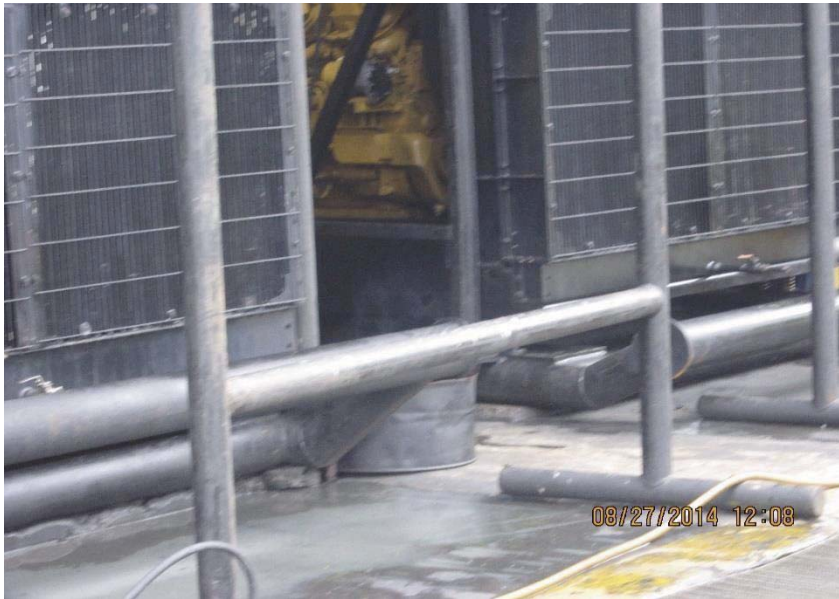
Ilustración 5 Recipiente con químico que obstaculiza el libre tránsito además es fuente de gases químicos y peligro de caída al mismo nivel y de contacto térmico
