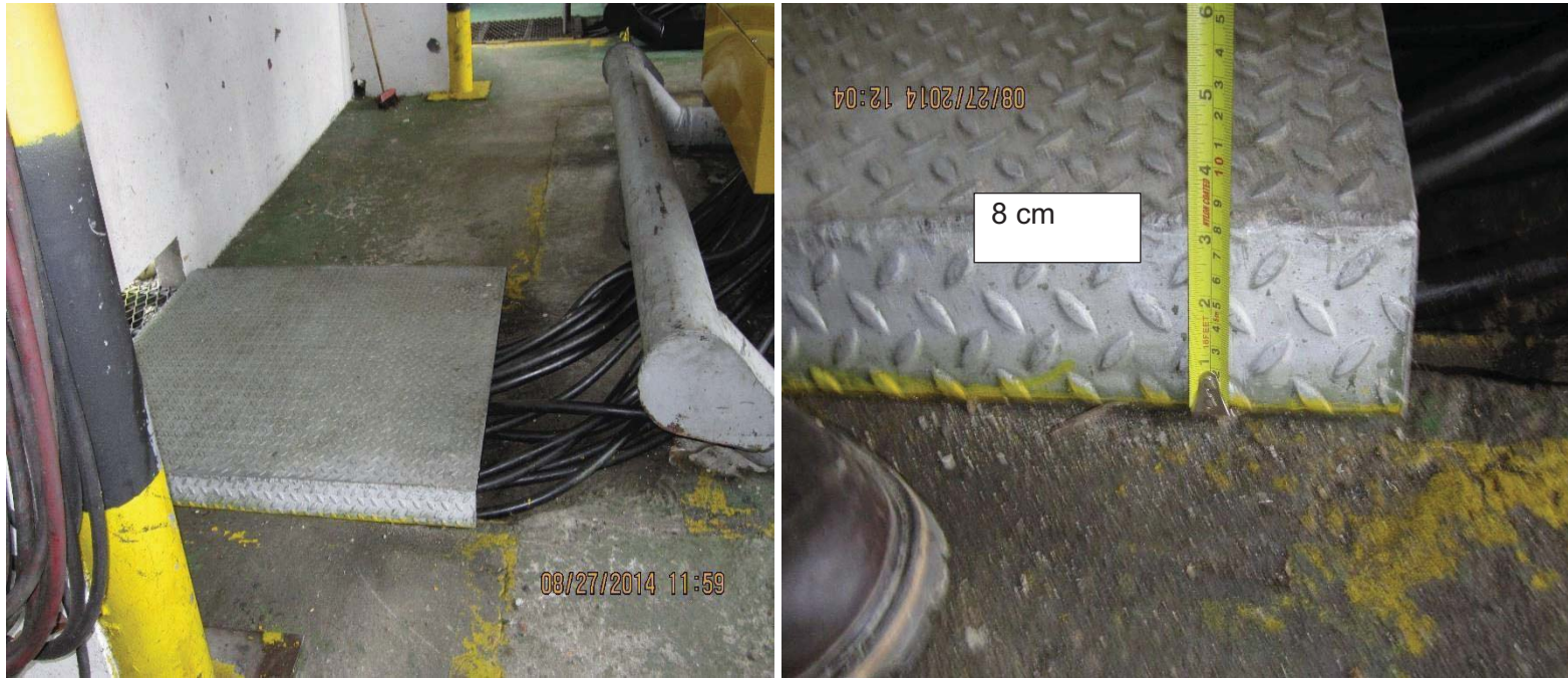
Ilustración 12 RODAPIES PROTECTOR DE CABLES CON ALTURRA INADECUADA
