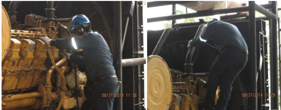
Gráfico N° 12: Trabajos de Mantenimiento de Grupos Electrógenos.
