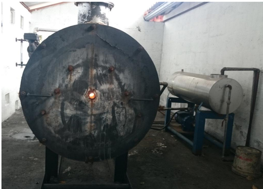
FIGURA 18 Punto de emanación de calor no aprovechado al medio ambiente
