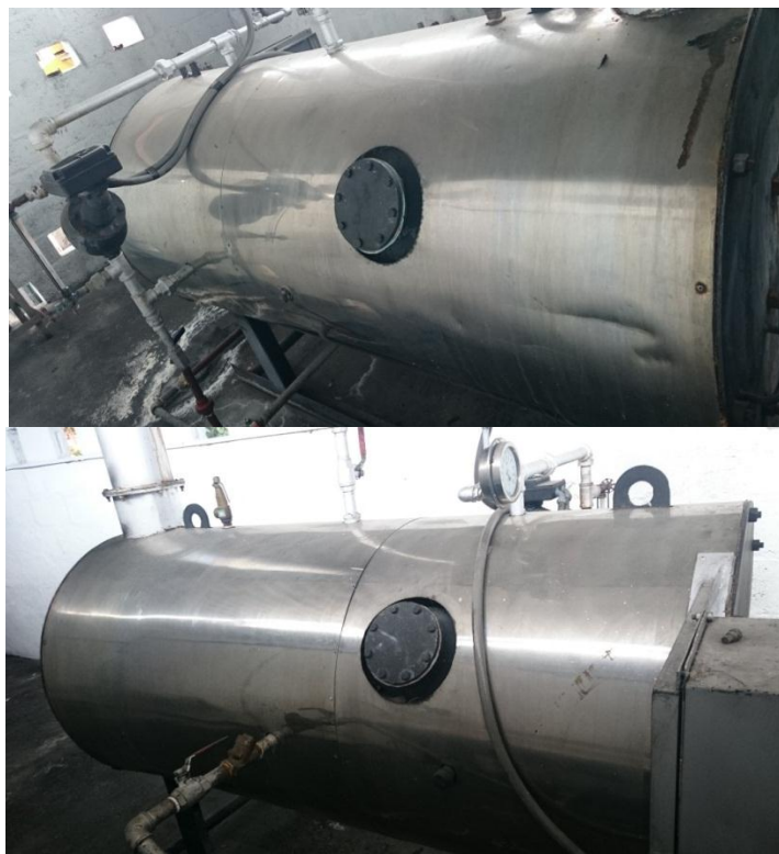
FIGURA 17 Superficies puntuales de la caldera sin aislamiento térmico
