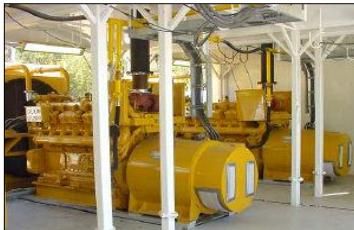
Figura 4.3 Sistema de Potencia
