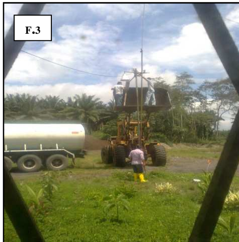
F.3.: Actitudes inseguras: 2 trabajadores realizando trabajos sobre pala mecánica
