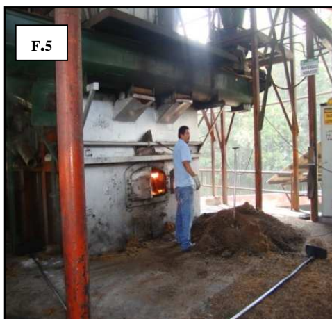
F.5.: Peligro de incendio. Encargado de calderos dejó abierta la escotilla.
