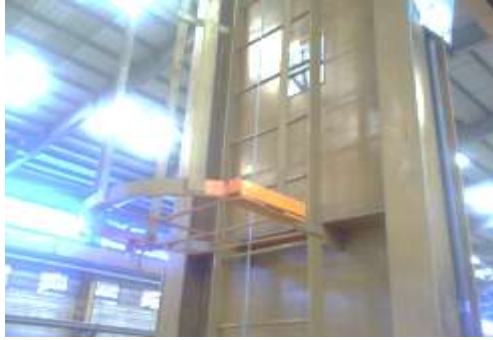
Ilustración 18: Control de accesos 1 Fuente: INCA
