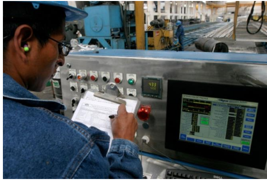
Figura 6. Tablero de control extrusión Fuente: CEDAL, 2012
