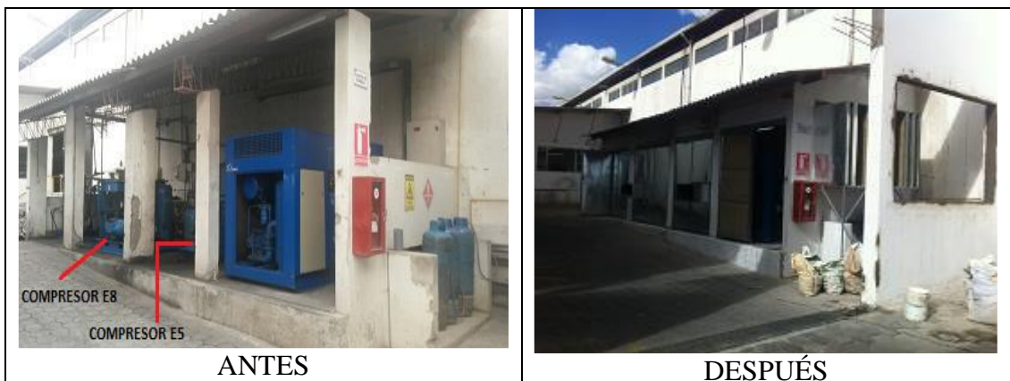
Figura 36. Zona de Compresores Elaborado por: G. Plaza Fuente: CEDAL, 2015
