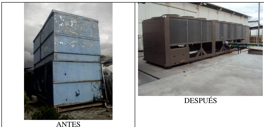
Figura 37. Sistema de Enfriamiento Chiller Elaborado por: G. Plaza Fuente: CEDAL, 2015
