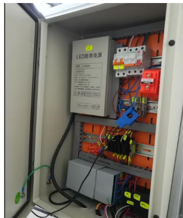
Figura 3.11. Caja de conexiones eléctricas y control caja 02
