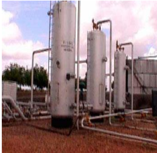
Figura 1.3. Tren de separación (separadores de alta presión, de baja y de prueba)
