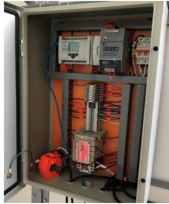
Figura 3.9. Caja de conexiones eléctricas y control caja 01
