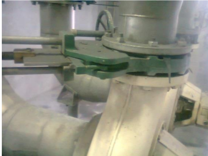
Figura 3. 7. Válvula estrangulada a la salida de una bomba Fuente. Grupo Familia.
