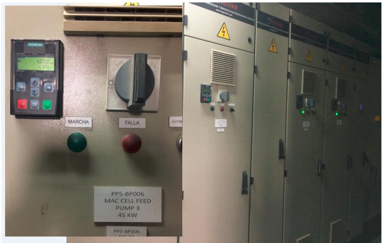
Figura 4. 7. Gabinete eléctrico externo
