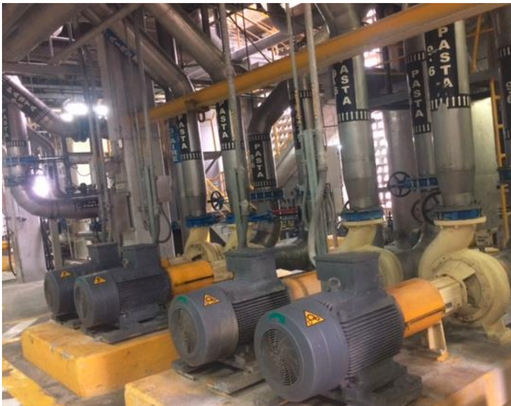
Figura 2. 3. Sistema de bombeo del área de flotación
