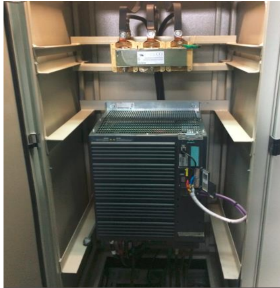
Figura 4. 6. Gabinete eléctrico interno
