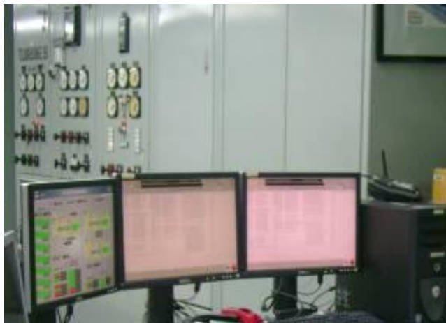
Figura 3.1 Cuarto de control del sistema de generación
