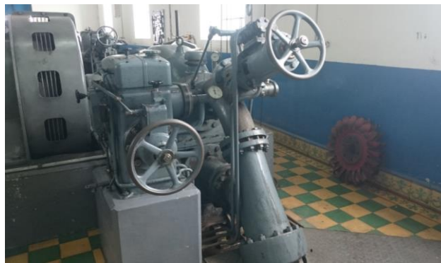
Sistema de control de inyección (las turbinas operan con dos inyectores)
