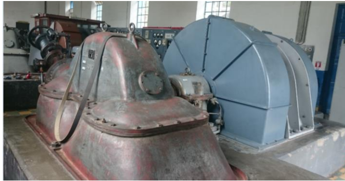
Sistema de generación hidroeléctrica ILLUCHI I
