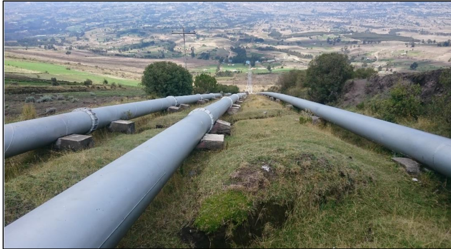
Figura 26. Túneles de carga Central de Generación Illuchi I.
