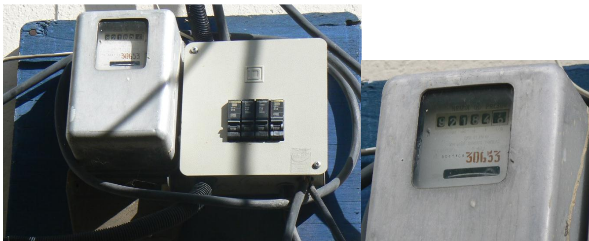
Figura 3.2. Medidor de energía eléctrica de la unidad educativa “Juan Abel Echeverría”.
