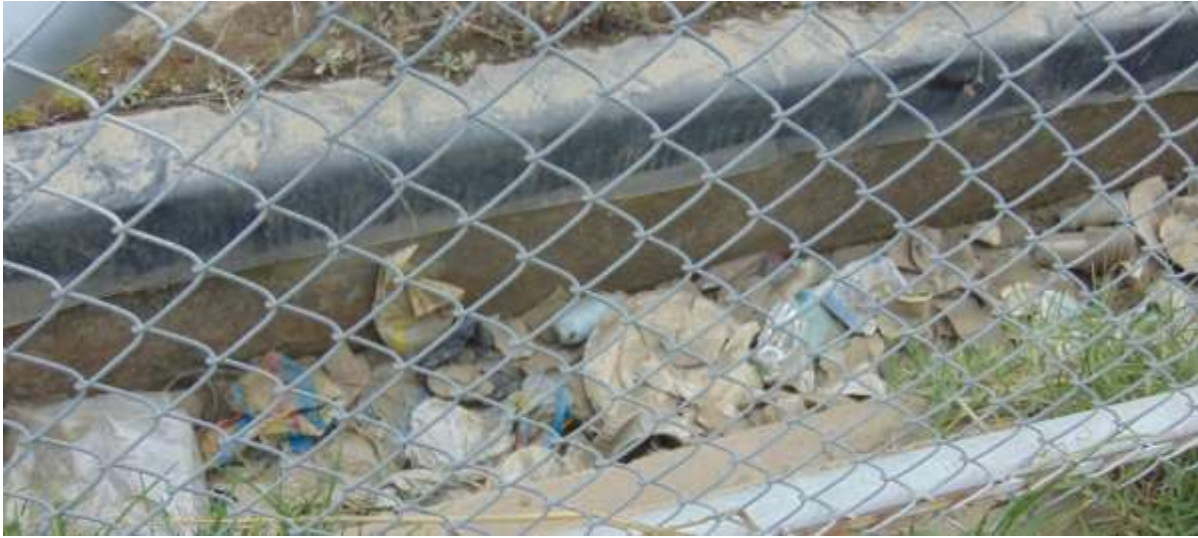
Fotografía 9. Canal de lixiviados
