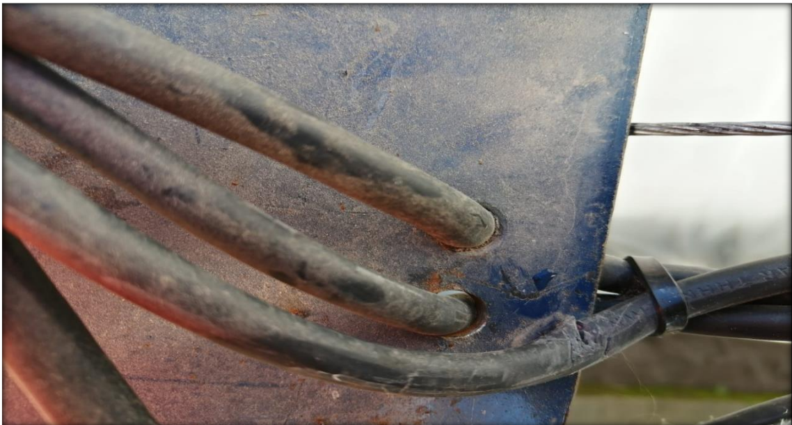
Anexo I. 2 Conductor en corto circuito con la base metálica
