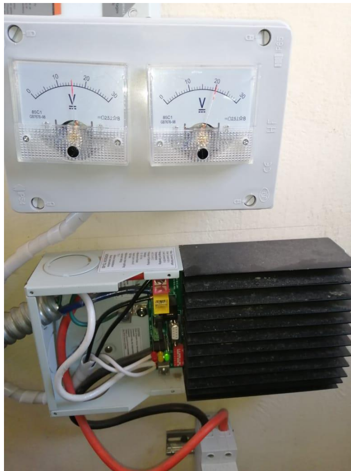
Fig. 17. Conexión del regulador de carga y el banco de paneles fotovoltaicos
