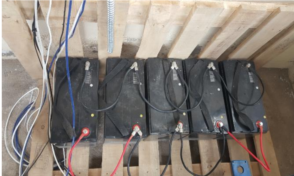
Fig. 18. Conexión del banco de baterías
