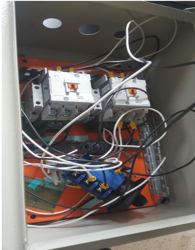
Fig. 21. Conexión de las salidas del inversor con el tablero de transferencia de energía
