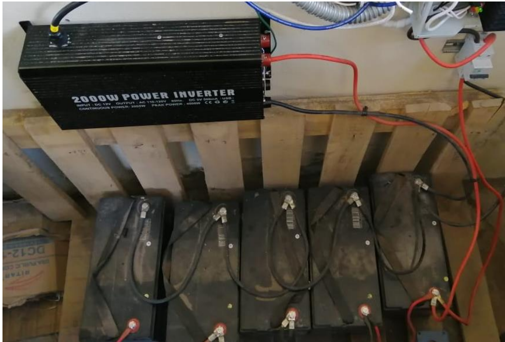
Fig. 20. Conexión entre el banco de baterías y el inversor
