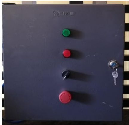
Figura 4.15. Tablero de control
