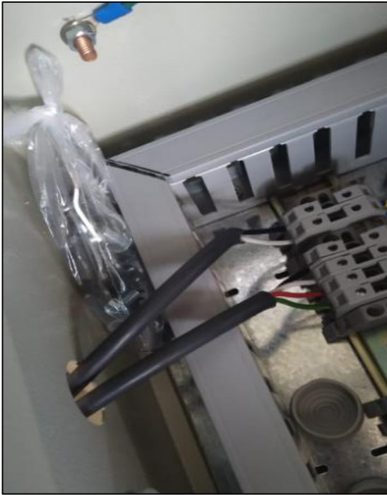
Fotografía 24: Cableado de controlador MT-530E. Fuente: Cuasquer C., Villegas J.
