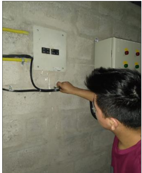
Fotografía 31: Conexión a línea de 220V. Fuente: Cuasquer C., Villegas J.
