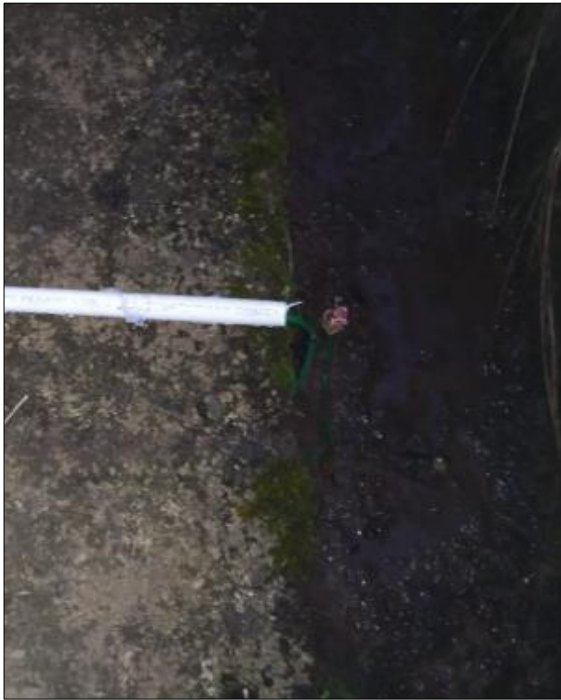
Fotografía 28: Puesta a tierra del sistema de control. Fuente: Cuasquer C., Villegas J.
