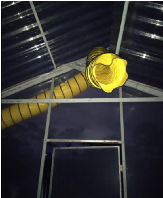
Fotografía 30: Distribución de aire caliente mediante manga térmica. Fuente: Cuasquer C., Villegas J.
