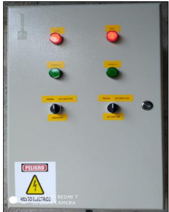
Fotografía 19: Marquillado de caja de control. Fuente: Cuasquer C., Villegas J.
