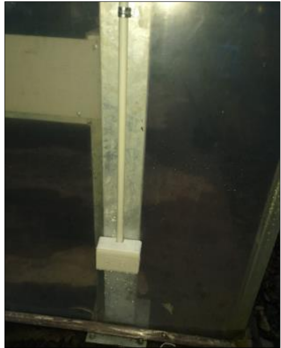
Fotografía 29: Alimentación para actuador. Fuente: Cuasquer C., Villegas J.
