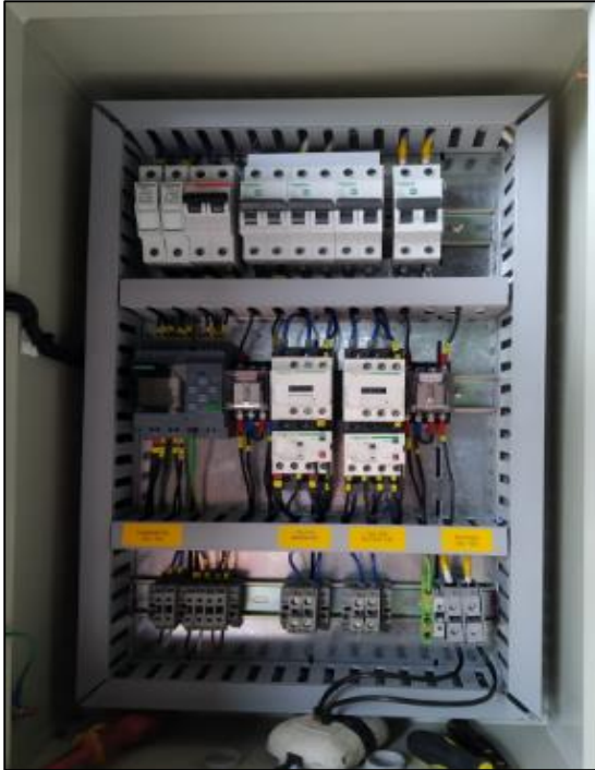
Fotografía 16: Cableado de la caja de control. Fuente: Cuasquer C., Villegas J.
