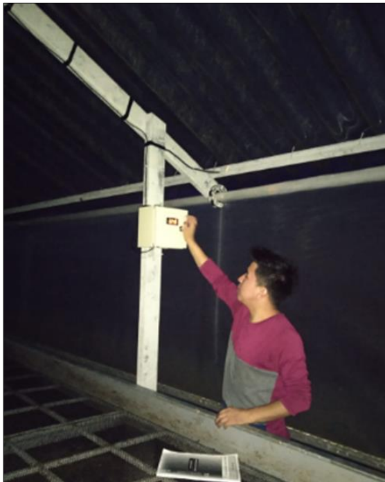
Fotografía 26: Instalación de controlador MT-530E. Fuente: Cuasquer C., Villegas J.
