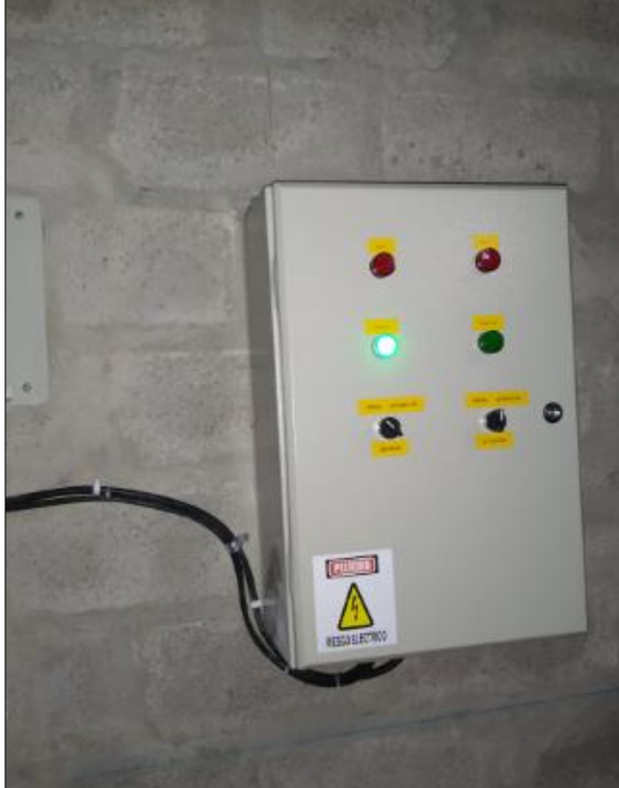
Fotografía 32: Funcionamiento del sistema forma manual. Fuente: Cuasquer C., Villegas J.
