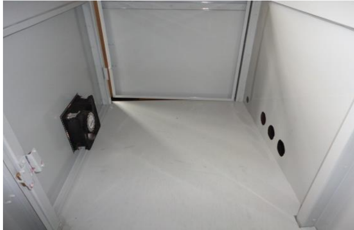
Vista interior del compartimiento eléctrico
