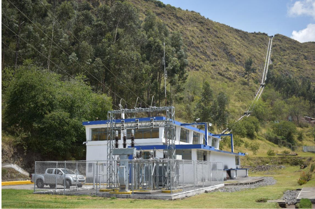
Ilustración 1. Central Hidroeléctrica Illuchi N° 2
