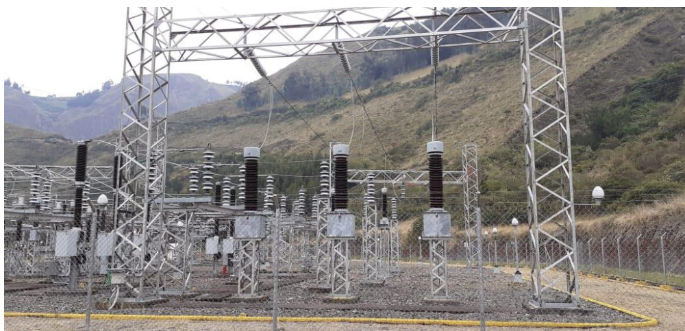
Figura 3.1. Subestación de seccionamiento Pucará.
