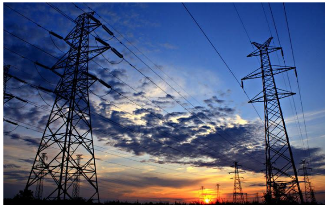
Figura 3. 18. Infraestructura de una línea de transmisión [29].
