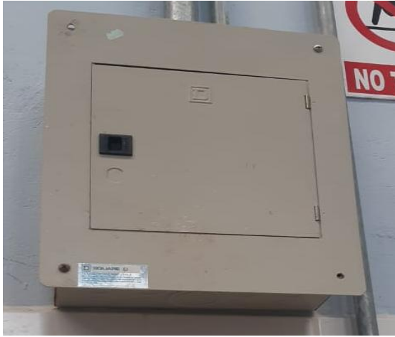
Fotografía 3. Caja de control de energía
