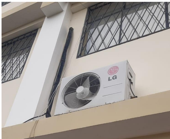
Fotografía 9. Sistema de calefacción
