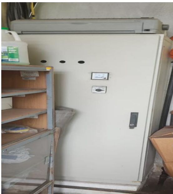
Fotografía 7. Caja de distribución de energía
