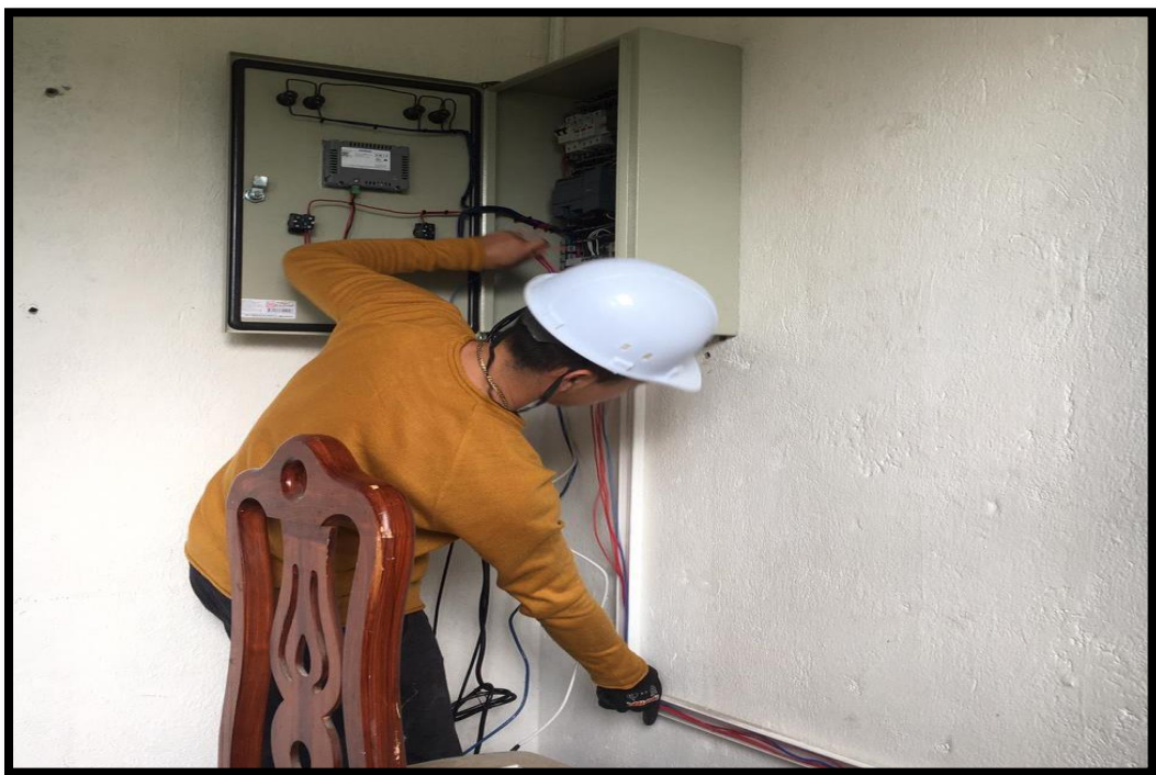
Figura XI.1: Cableado de bombas
