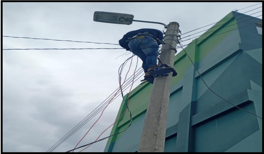
Figura III.1: Instalación de alimentación
