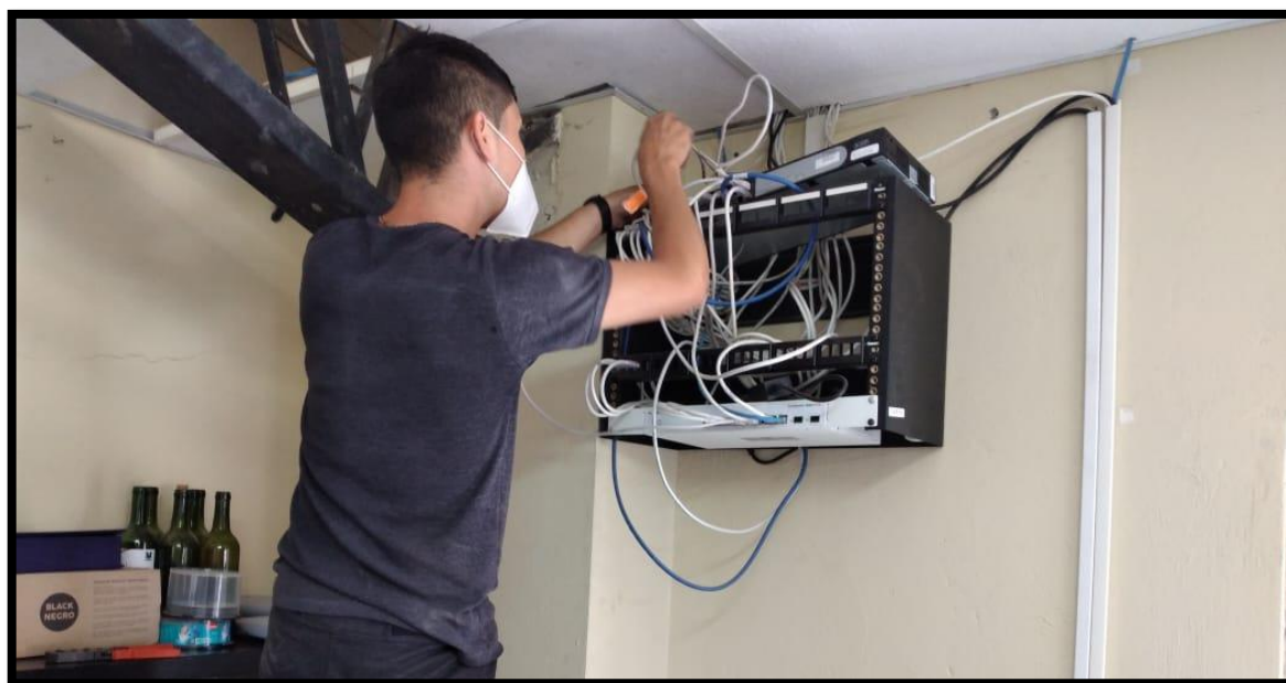
Figura XXII.1: Instalacion de la rack de datos hacia la antena
