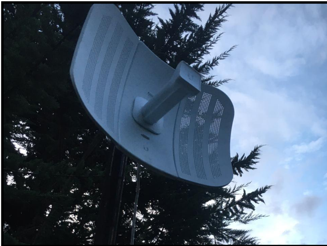
Figura XXI.1: Colocacion de antena ubiquiti punto a punto
