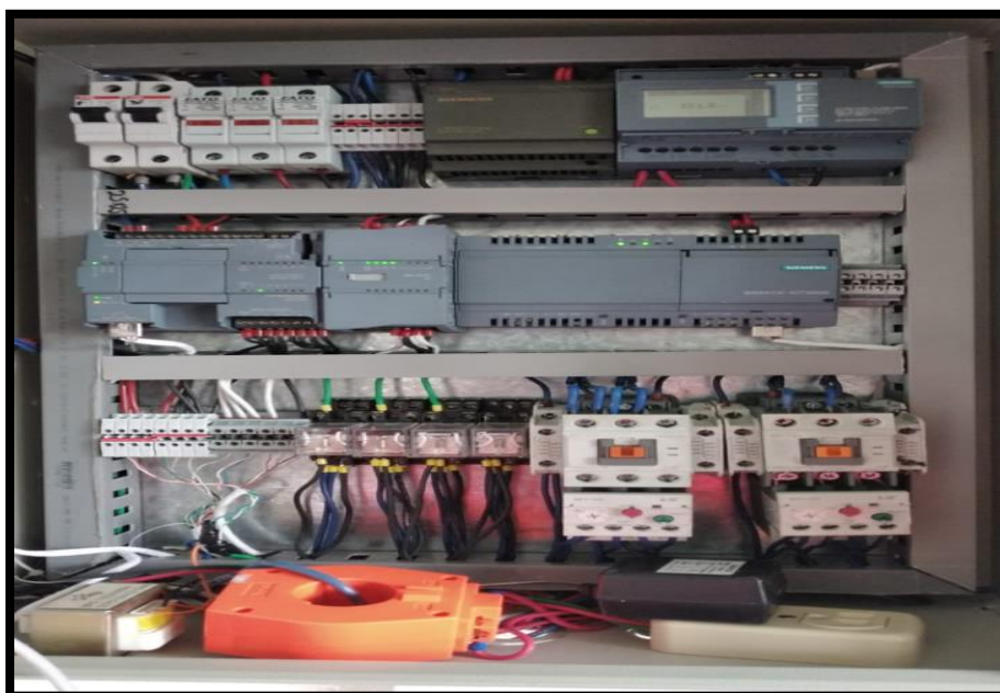
Figura XXIV.1: Conexión total del tablero
