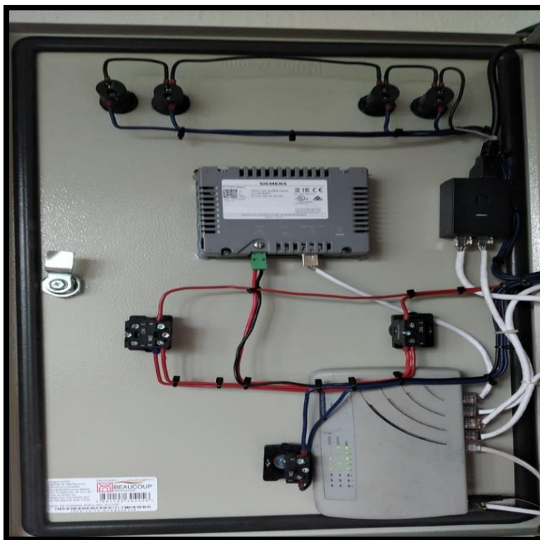
Figura XXV.1: Conexión de KPT y Router para transmisión de datos
