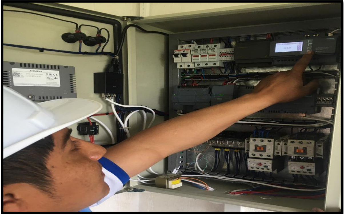
Figura XII.1: Pruebas de alimentacion del tablero de control
