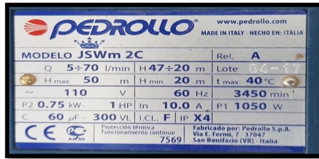
Figura 5.2: Datos de la placa de las bombas centrífugas.
