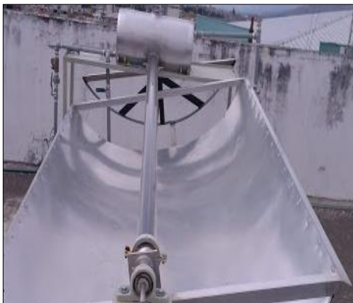
Fotografía 5: Base reflectora con el tubo de calor y el tanque de almacenamiento
