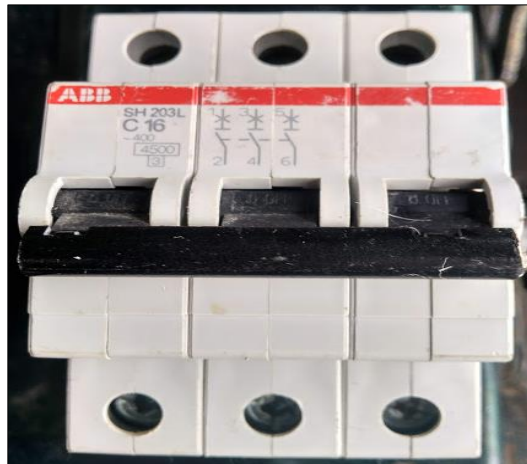
Figura 9: Breaker o disyuntor trifásico[ADPA4]
