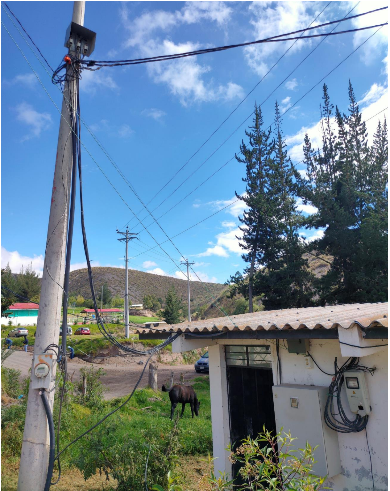
Figura D.1. Banco de capacitores aguas arriba del medidor
