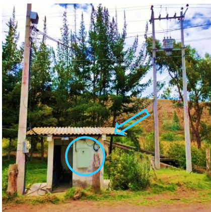
Figura 5.2 Banco de capacitor a repotenciar.
