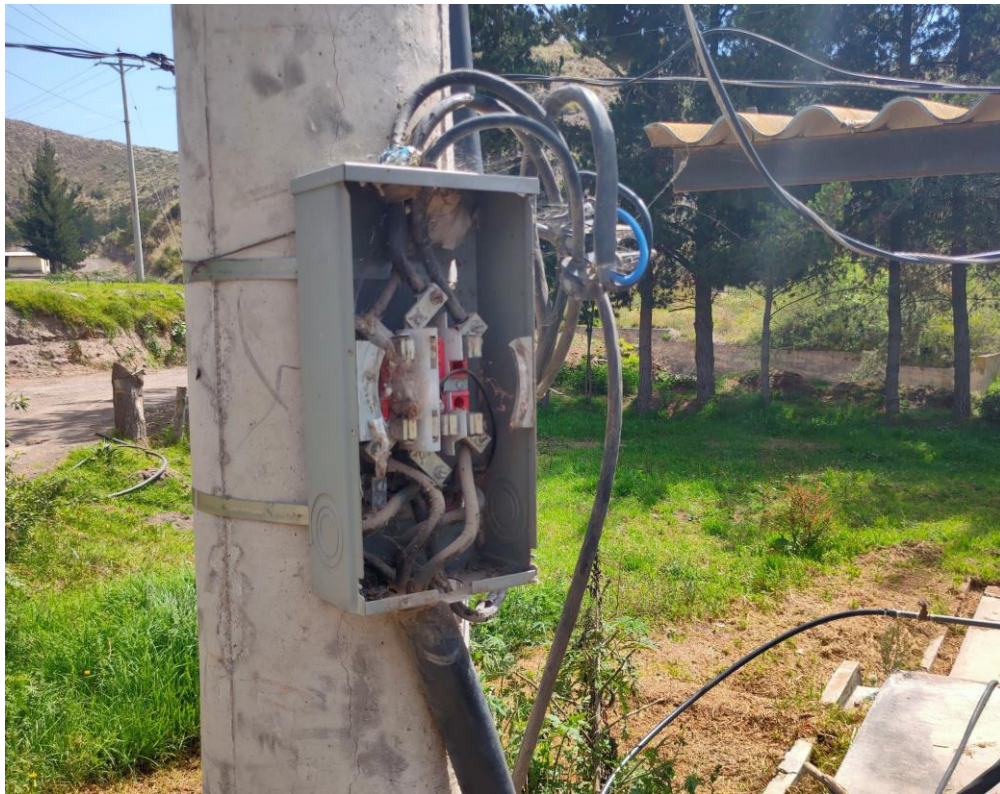
Figura D.4. Modificación del banco de capacitores.
