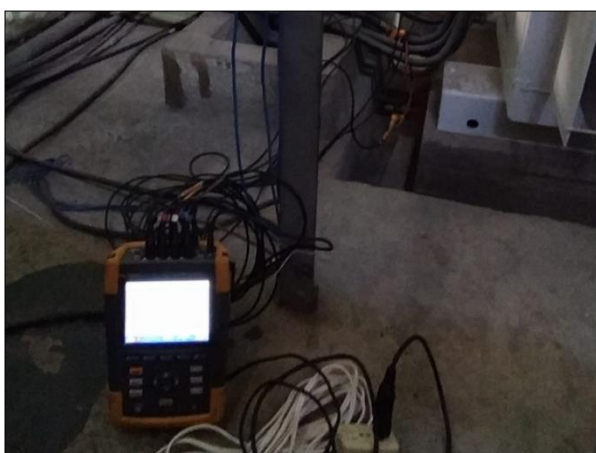
(a) Analizador trifásico de energía y calidad de la energía eléctrica FLUKE 435-II – Transformador 1 (600 kVA).
