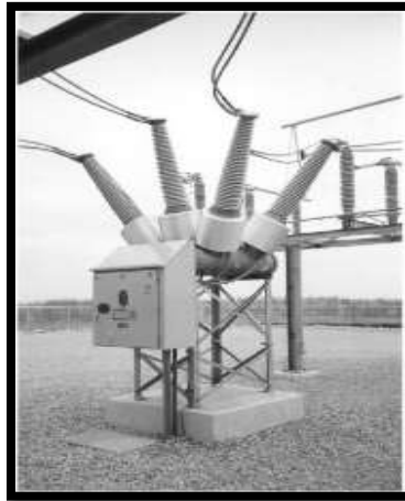
Figura 24. Interruptores de potencia.
