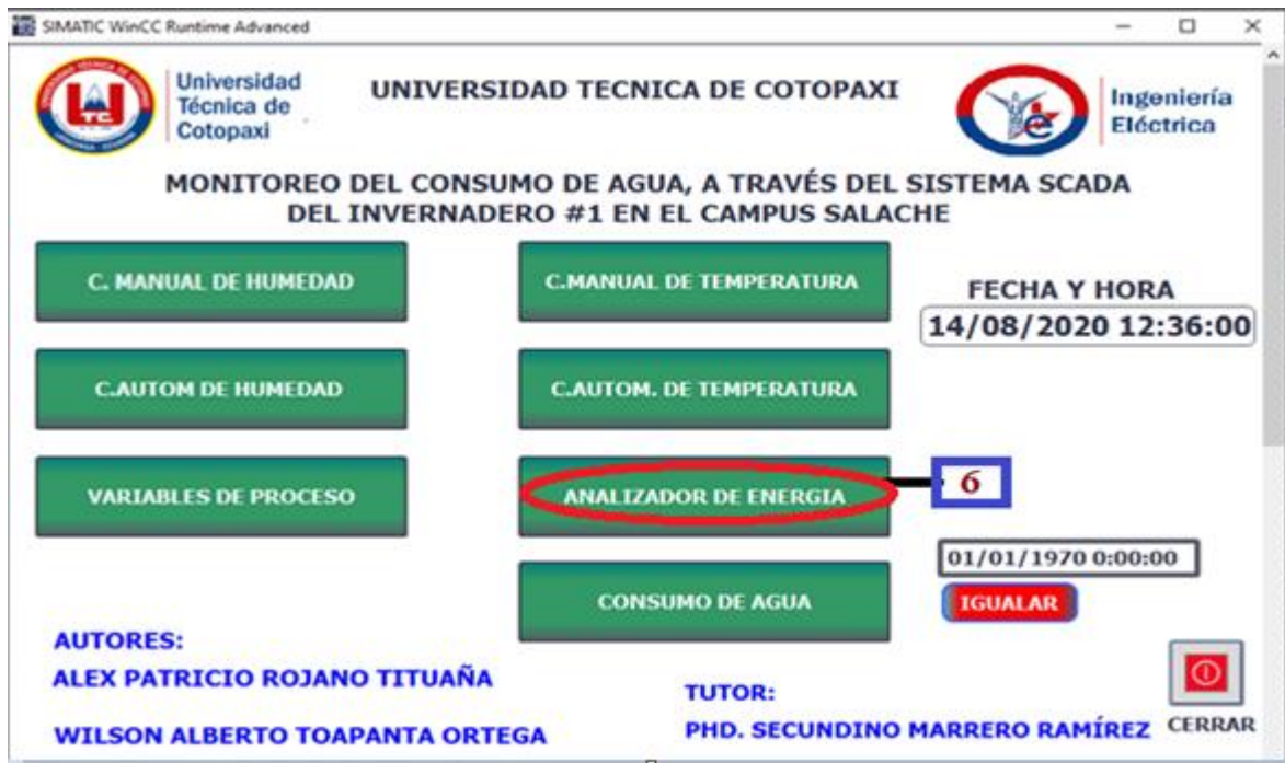
Imagen 14 Pantalla principal seleccionando ANALIZADOR DE ENERGÍA
