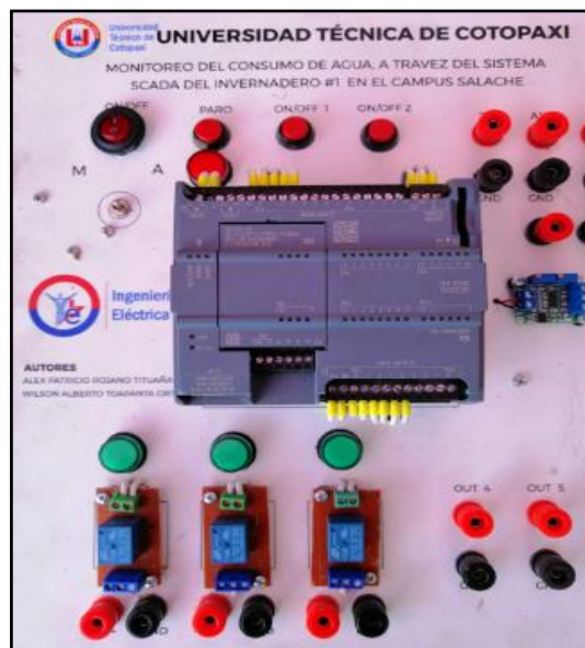
Anexo II.1 Tablero del control.
