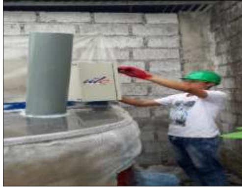
Figura 49 Tablero de control implementado a la máquina secadora de cacao.
