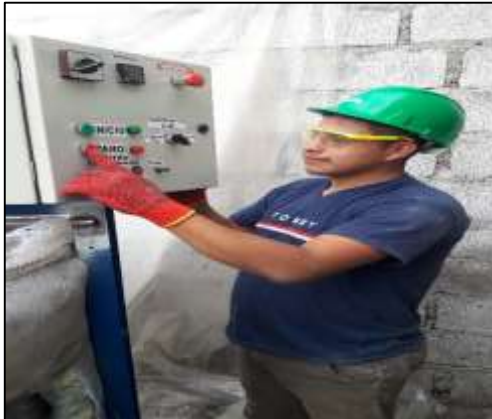
Figura 60 Comprobación de los pulsadores y luces piloto
