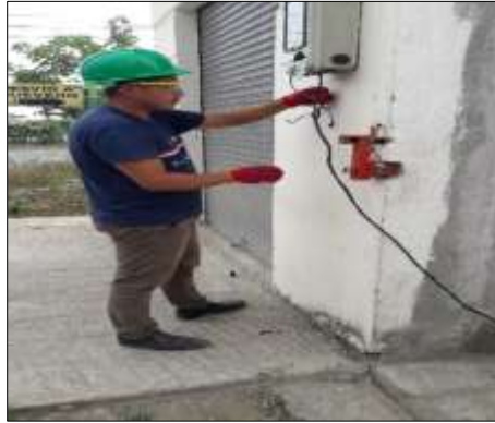
Figura 54 Instalación a 220 (CA) desde el medidor
