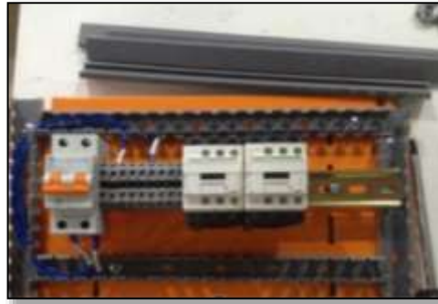
Figura 46 Armado de canaletas y riel DIN para el acople de los dispositivos eléctricos.
