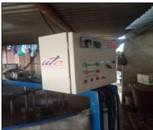
Figura 62 Identificación de los componentes del tablero de control
