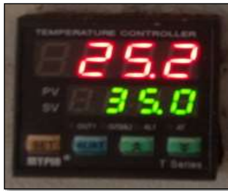
Figura 55 Instalación del lector de temperatura digital
