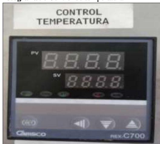
Fotografía 9: Control de temperatura
