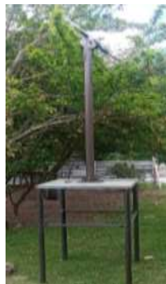
Figura 5. 13. Soporte del panel, batería, energizador y controlador
