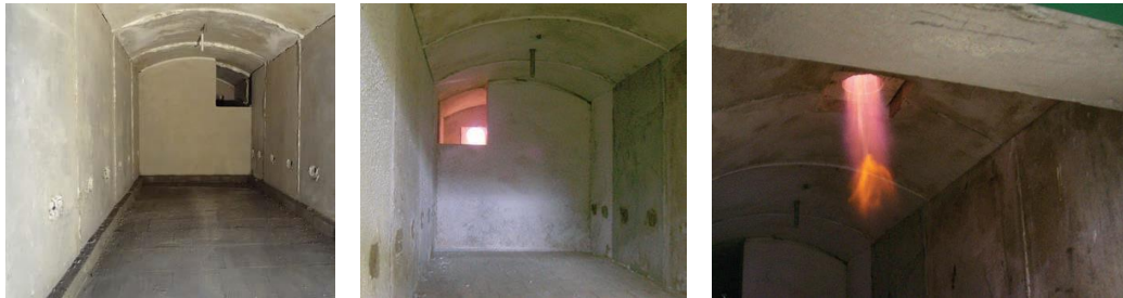
Ilustración 11 Horno crematorio - cámaras de combustión
