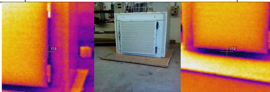
Figura G.1. Perdidas de calor halladas en la parte inferior de la puerta
