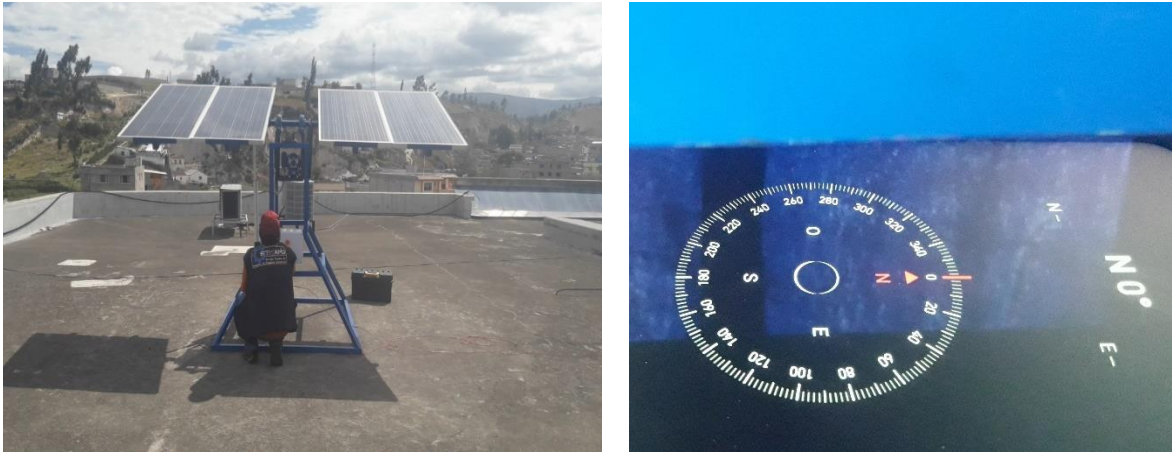
Figura 5. 10 Montaje y orientación de seguidor
