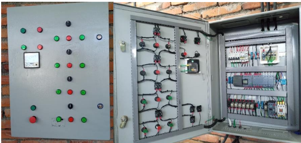
Figura 4.17 Tablero de control de la máquina extrusora
