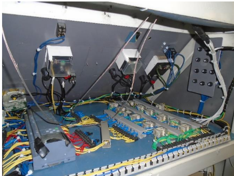
Figura 5.1 Estado eléctrico anterior de la máquina extrusora
