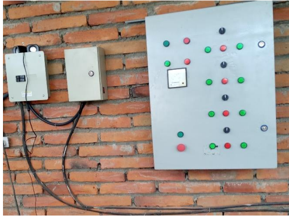
Figura 5.2 Estado eléctrico actual de la máquina extrusora
