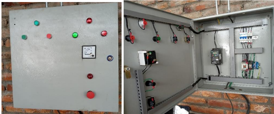
Figura 4.23 Tablero de control de la máquina extrusora
