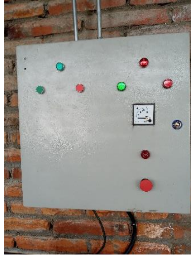
Figura 5.6 Tablero de control actual de la máquina tensora
