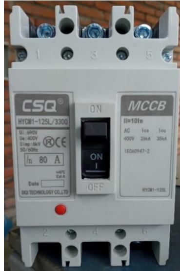
Figura 4.12 Interruptor termomagnético general del proceso
