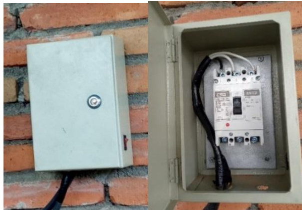
Figura 4.16 Tablero de protección principal
