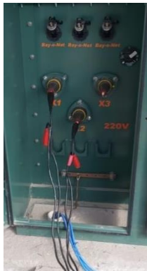
Figura 16. Conexión en el transformador.
