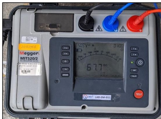
Figura 4. 28. Megger en funcionamiento conectado al transformador Pau Mounted.
