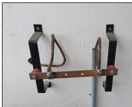
Figura 4. 19. Barra de puesta a tierra para el transformador de pedestal
