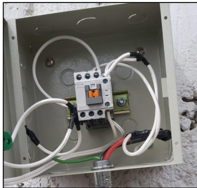
Figura 4. 22. Conexión del contactor para el control de la señalización.
