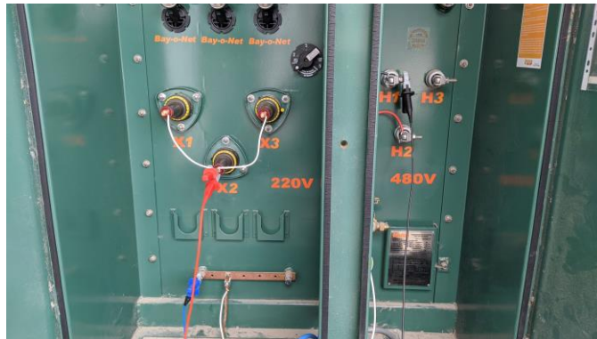
Figura 13. Conexión al transformador.
