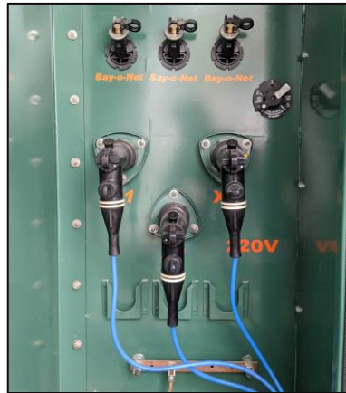
Figura 4. 8. Alimentación del lado primario del Transformador.
