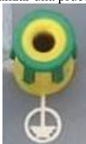
Figura 5. Terminal de puesta a tierra.
