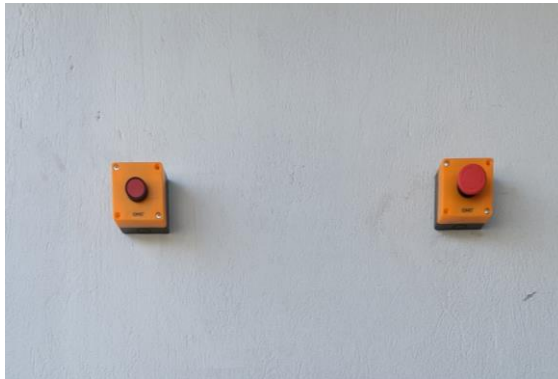
Figura 7. Pulsadores de apertura del Patio.
