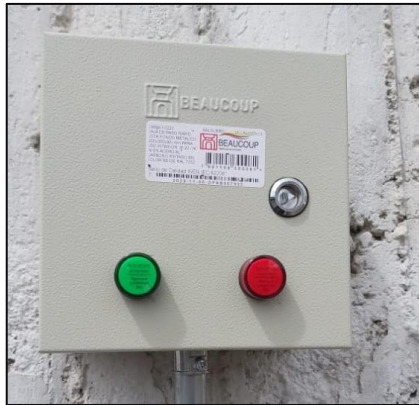
Figura 4. 23. Señalización del funcionamiento de seccionador
