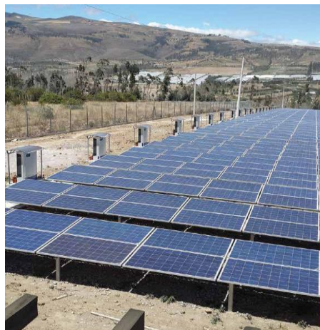
Figura 12. Arreglo de los paneles fotovoltaicos.
