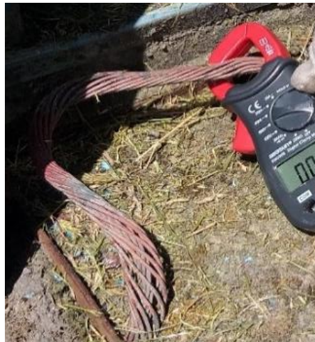
Figura 3. 3. Conductor de conexión a tierra de cobre 4/0 AWG.
