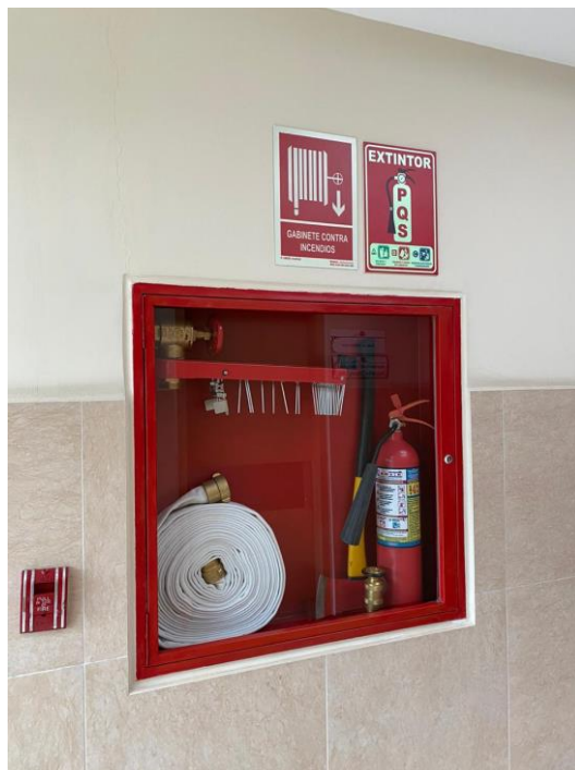
Figura N°22: Gabinete en Área Administrativa
