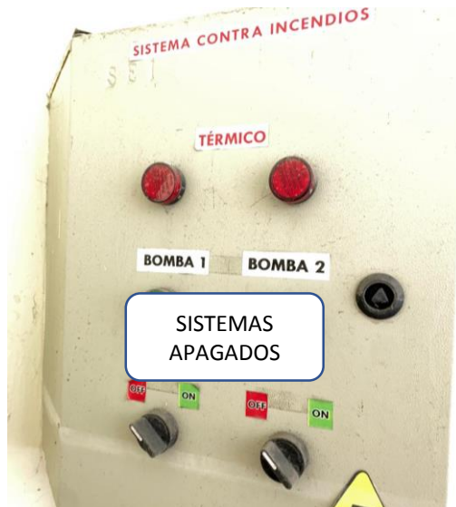
Figura N°17: Tablero De Control
