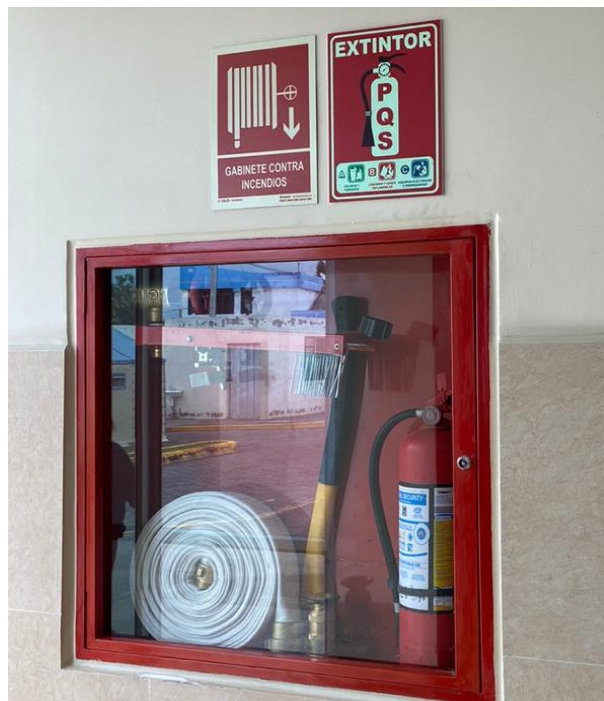
Figura N°20: Gabinete en Emergencia
