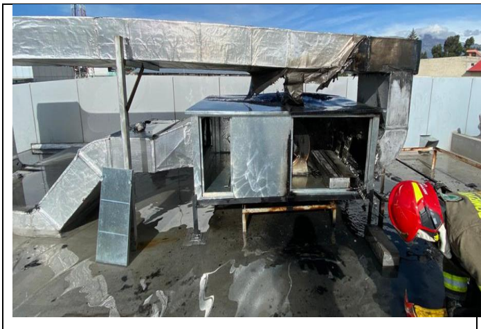
Figura N°1: Incendio 24 de octubre de 2020
