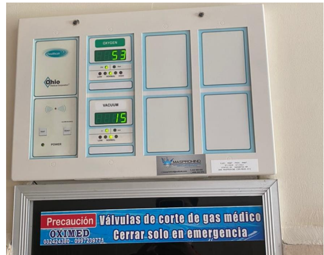
Figura N°28: Válvulas de Control de Oxígeno Fuente: Los Autores
