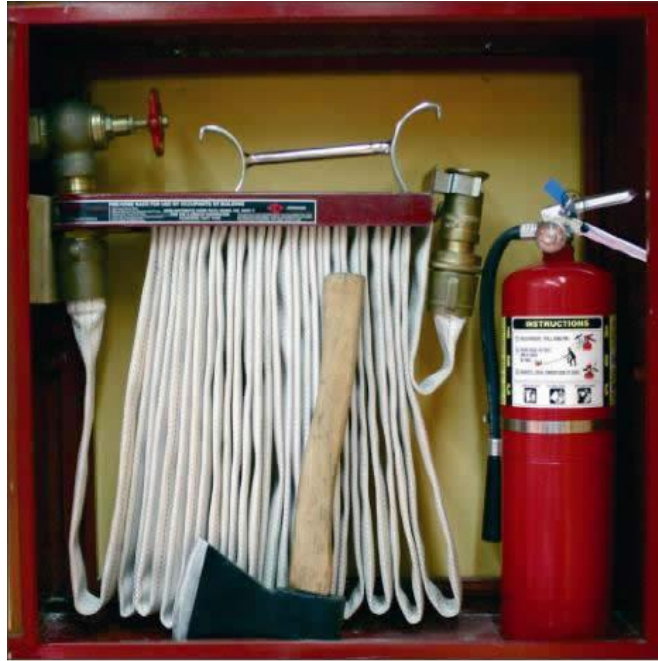
Figura N°34: Gabinetes contra incendios Tipo II con equipamiento Fuente: (Seguridad, 2017)
