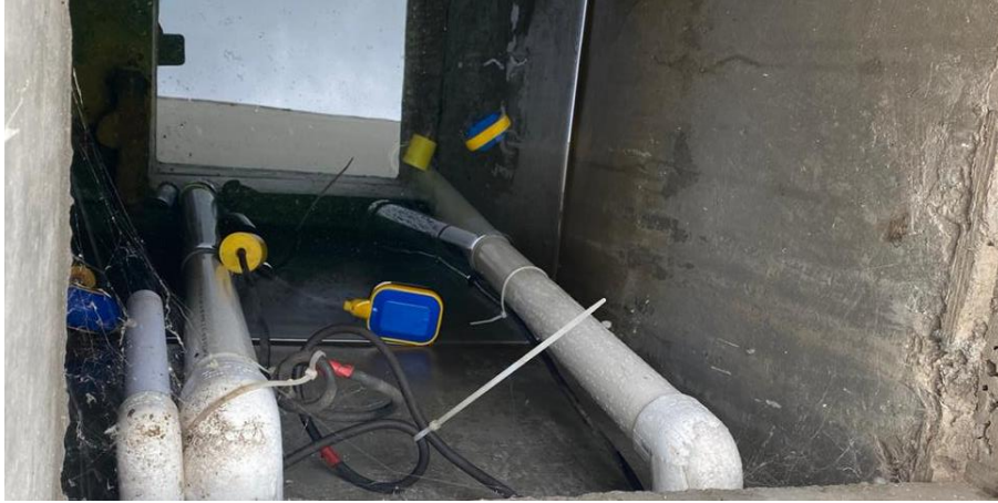
Figura N°15: Cisterna Contra Incendios Fuente: Los Autores
