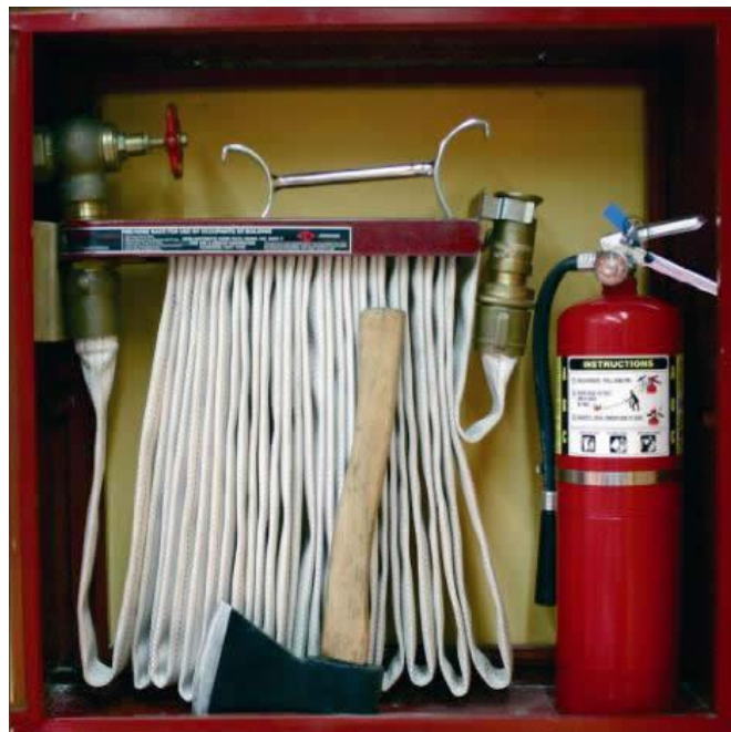
Figura N°7: Gabinete Contra Incendios Clase II
