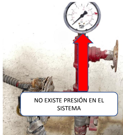
Figura N°18: Manómetro De Presión
